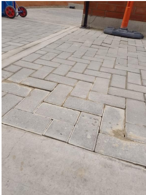
Foto 7. Adoquín circulación vehicular suelto
