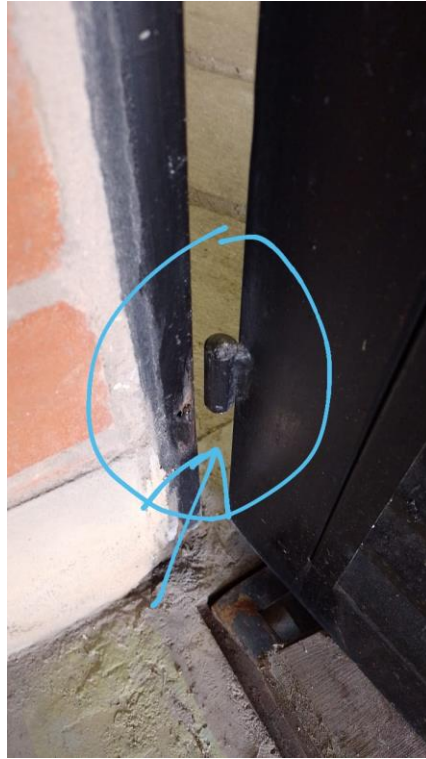
Foto 65. Bisagra suelta en el parte inferior cuarto de basuras pp
