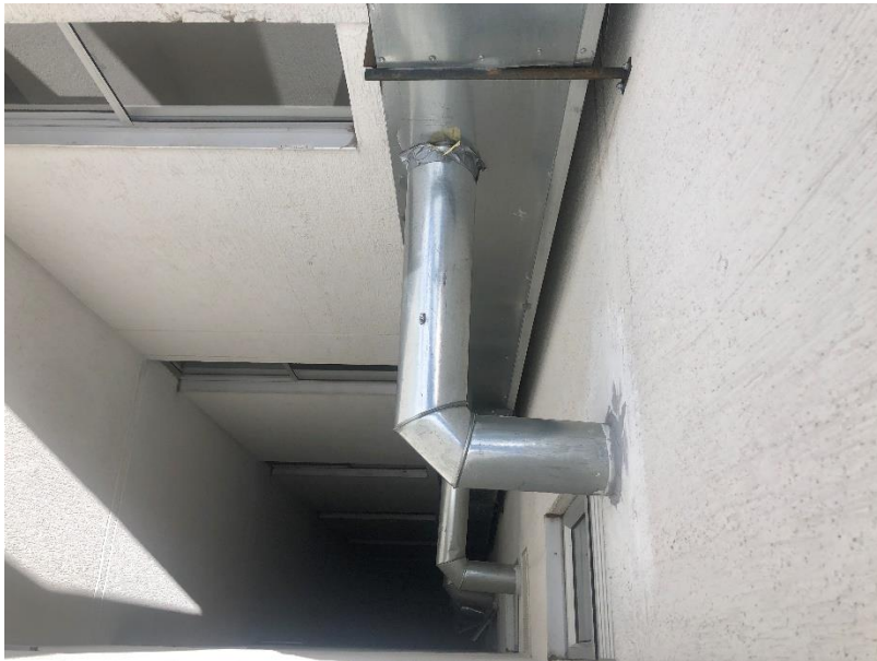
Foto 86. revisar uniones del ducto
