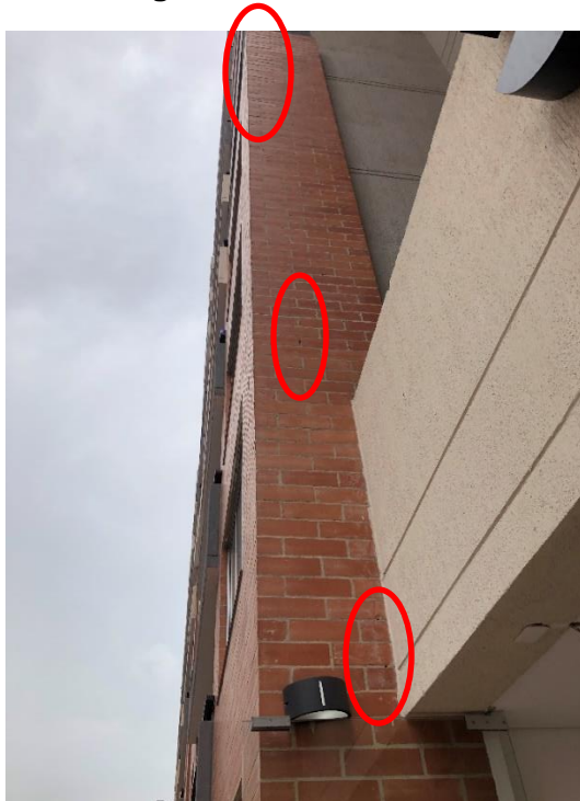
Foto 135. Foto 128. huecos en general en mortero de muros exteriores
