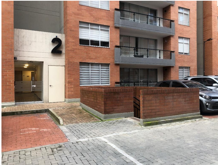
Foto 4. Humedad en escaleras frente a torre 2
