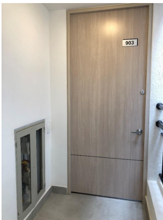
Foto 170. falta vidrio gabinete 903
