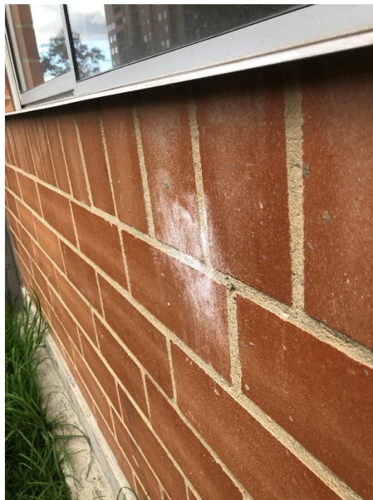
Foto 137. eflorescencia fachada posterior torre 3
