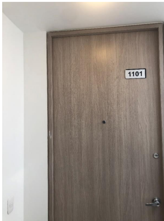
Foto 92. Manchas de pintura en marcos
