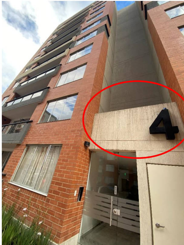
Foto 157. manchas negras y deterioro de pintura
