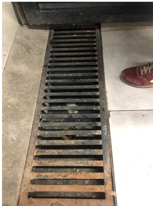
Foto 54. Sifón sin rejilla cuarto de basura Torre 1
