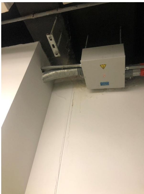
Foto 39. humedad placa de techo torre 5
