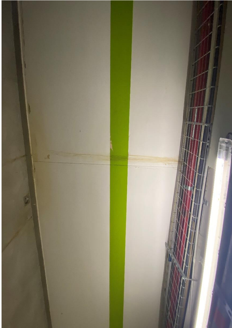
Foto 28 Filtraciones por fisura entre unión muro de contención sótano
