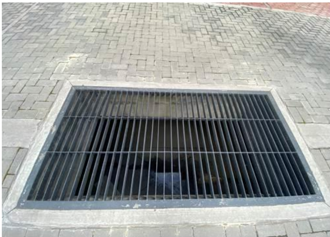
Foto 44 Adoquín este presentado deterioro prematuro
