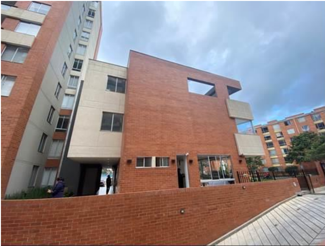
Foto 90 fachada portería manchada
