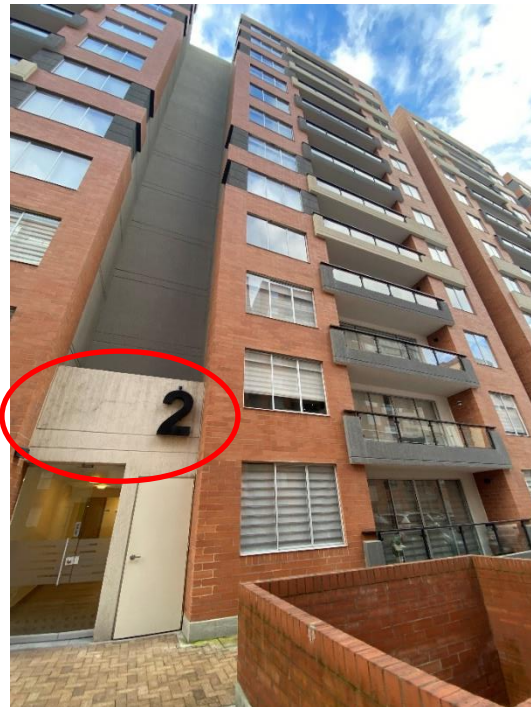
Foto 120. manchas negras y deterioro de pintura
