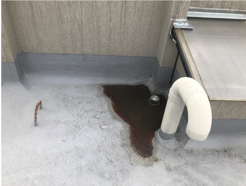
Foto 142. empozamientos de agua
