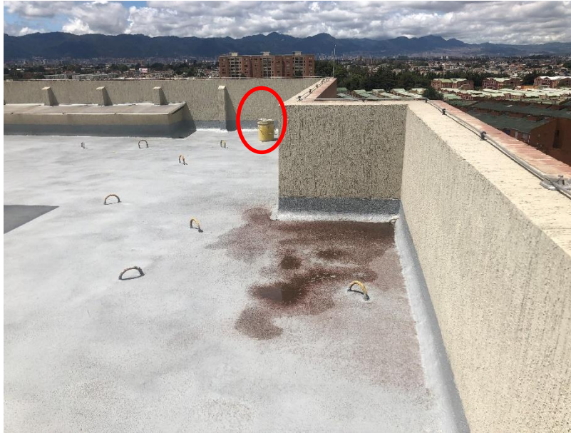
Foto 78. Empozamientos de agua en cubierta y materiales de construcción
