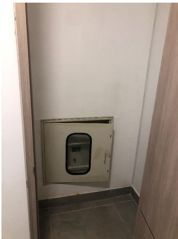
Foto 98. Mancha de oxido en pared bajo el gabinete de medidores
