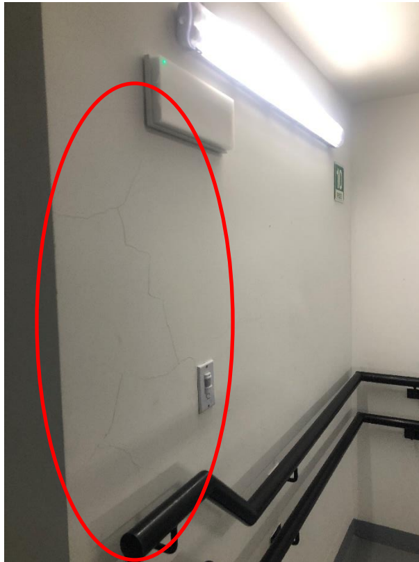
Foto 91. Fisuras punto fijo escaleras
