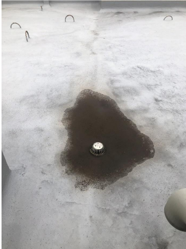
Foto 164. Empozamiento de agua
