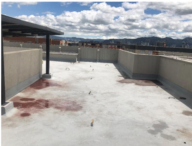
Foto 109. Empozamientos de gua
