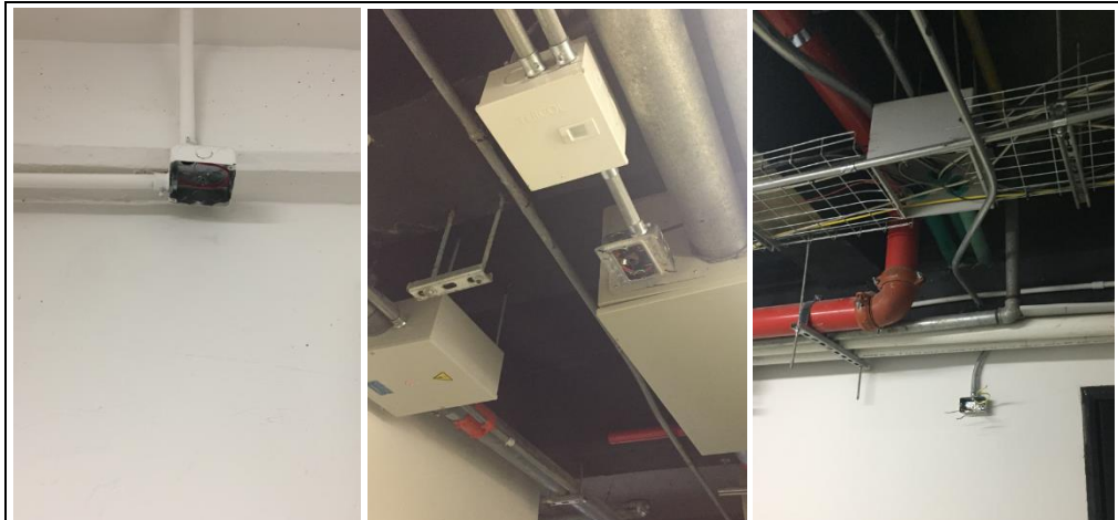
Fotografía 21. Cajas eléctricas de Paso. Fuente propia.
