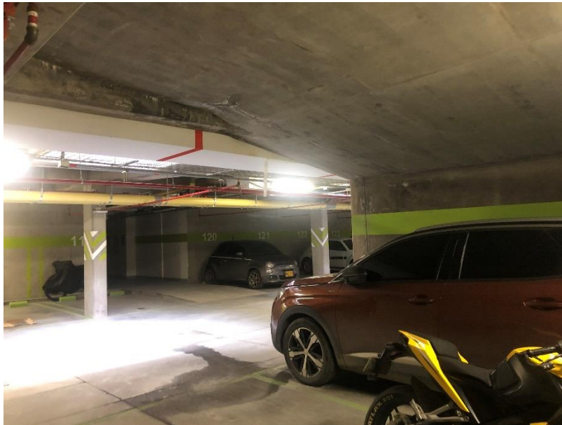
Foto 35. Humedad parqueaderos 242-243 y 244
