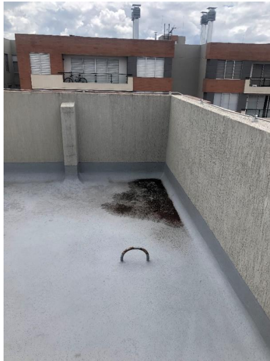
Foto 165. Empozamiento de agua
