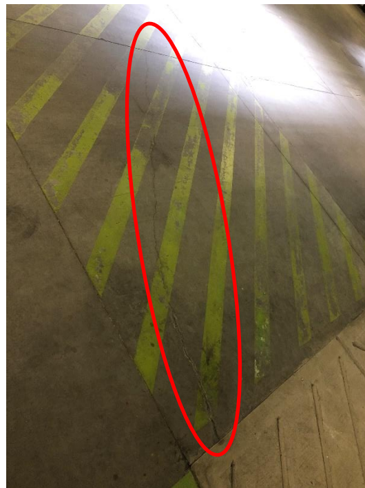
Foto 73. Fisura en placa de piso frente al hall hacia torre 3
