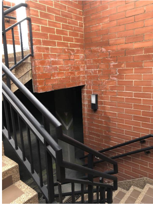
Foto 2. Muros Escalera con humedad salida hacia el parqueadero V-22
