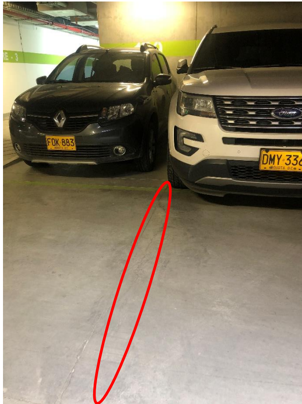
Foto 74. Fisura en placa de piso en circulación frente al parqueadero 139
