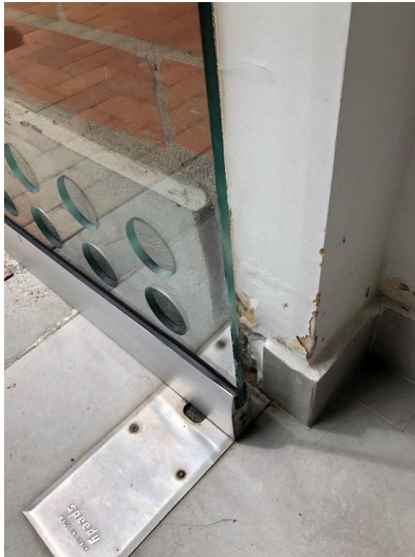
Foto 181. Humedad en muro inferior al ingreso de la torre
