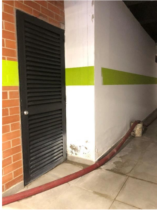
Foto 52. Humedad en muros de cuarto de bombas
