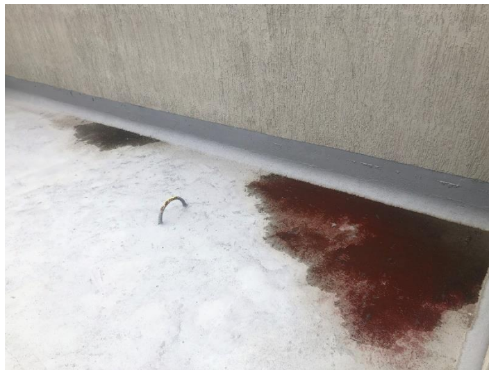
Foto 138. Empozamientos de Agua en cubierta
