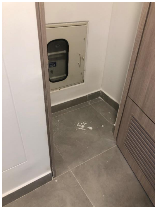
Foto 94. Manchas de pintura en piso
