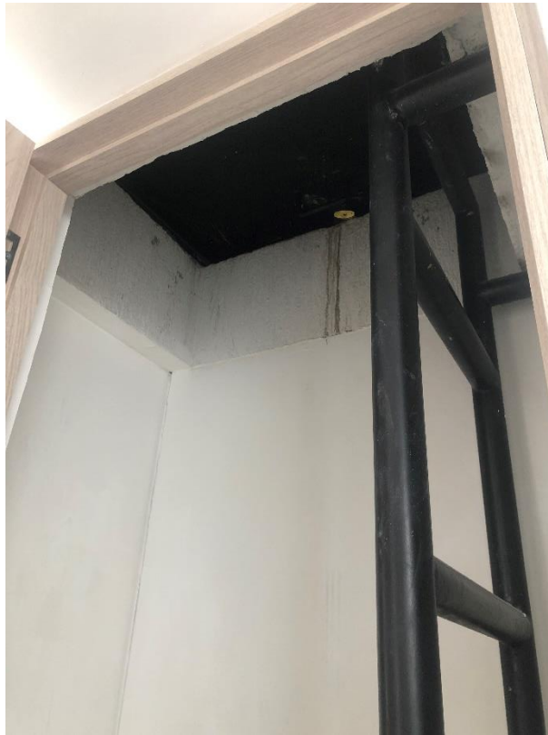
Foto 117. verificar filtración de agua por claraboya
