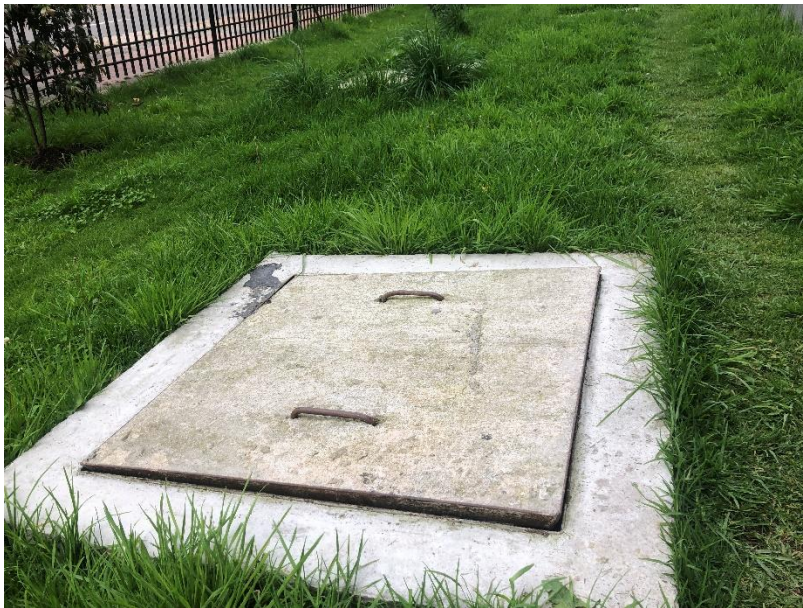
Foto 17. tapa no encaja en la caja y las manijas no bajan correctamente
