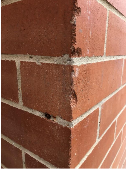
Foto 134. huecos en general en mortero de muros exteriores
