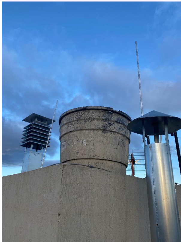
Foto 126. tanque de agua sobre cubierta del ascensor
