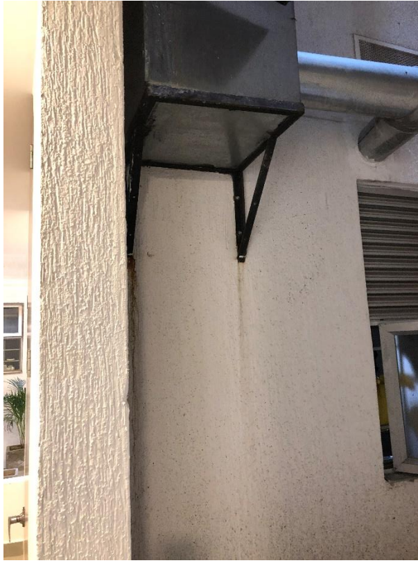
Foto 153. machas de oxido
