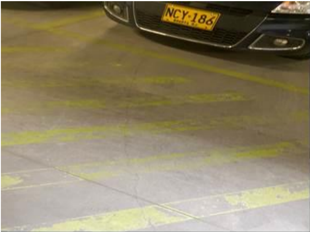
Foto 35 Fisura en placa de contrapiso parqueadero 229
