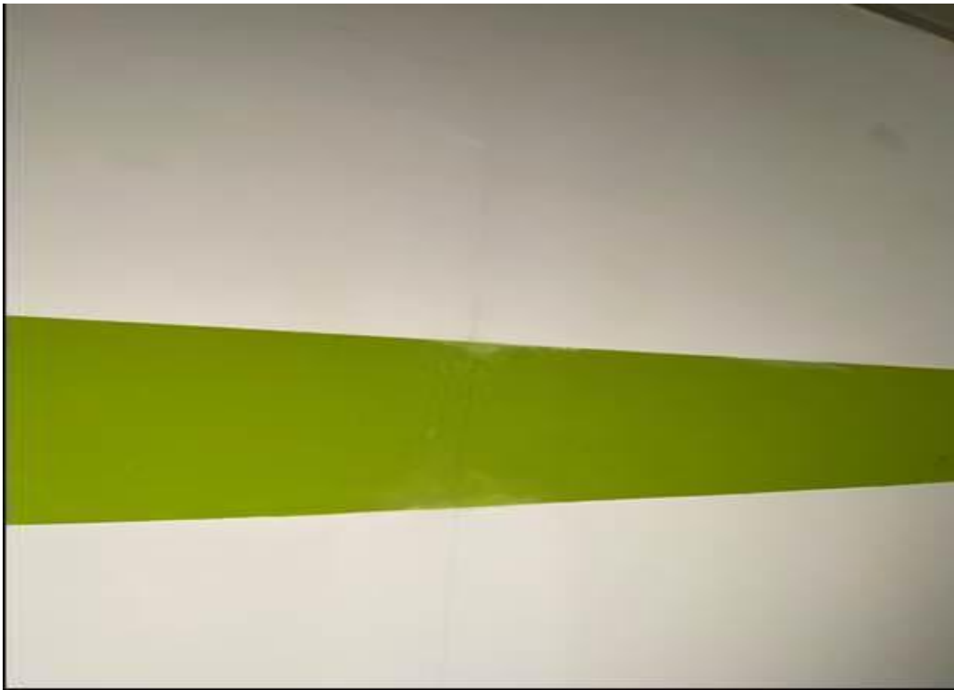
Foto 25 Filtraciones por fisura entre unión muro de contención sótano
