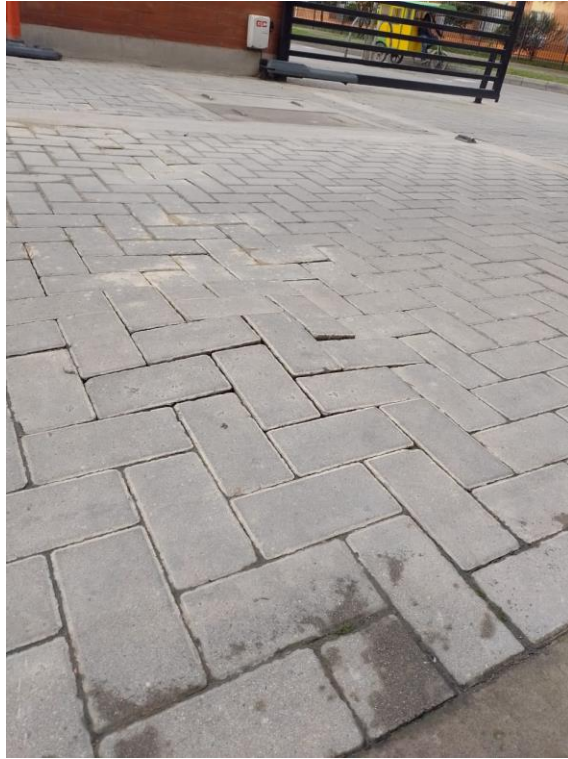
Foto 6. Adoquín circulación vehicular suelto
