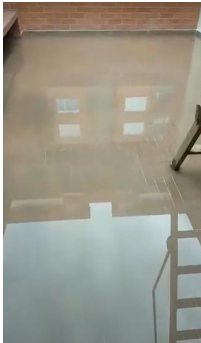
Foto 32. empozamiento de agua en terraza BBQ
