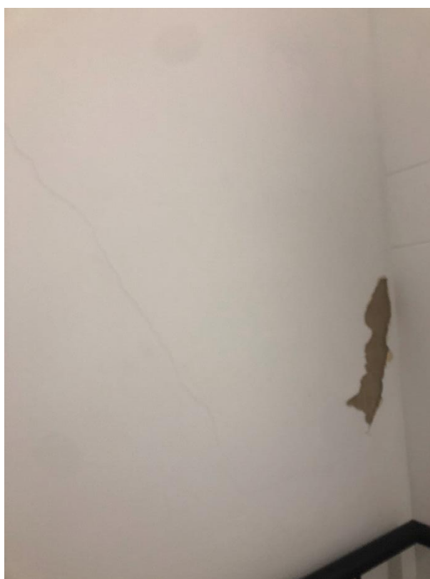
Foto 149. desprendimiento y fisuras en punto fijo escaleras
