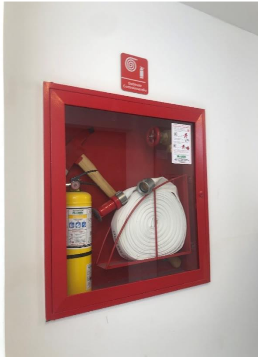
Foto 89. Gabinetes red contraincendios
