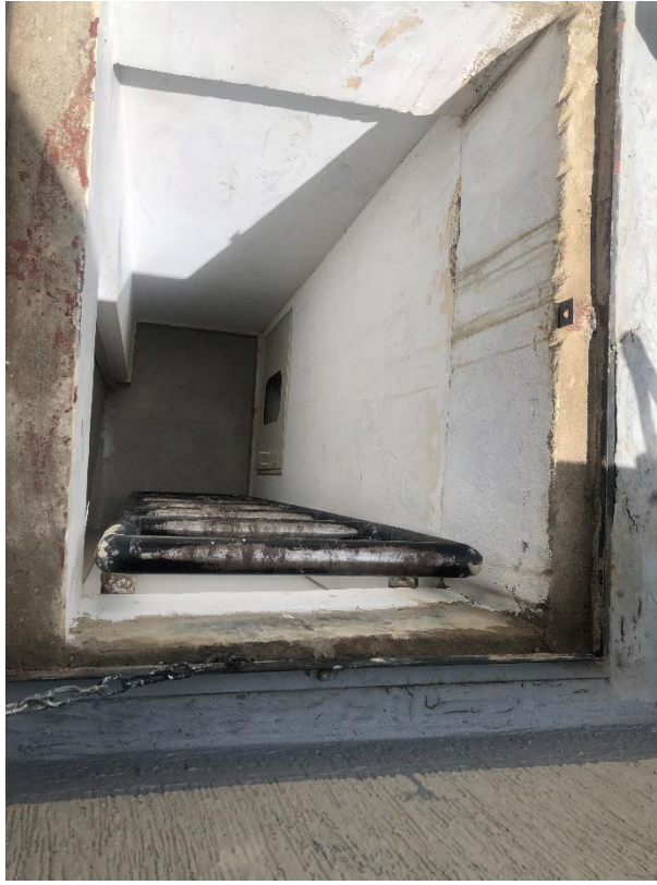
Foto 84. verificar filtraciones por claraboya
