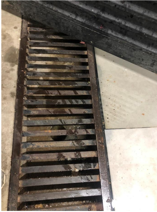
Foto 55. Sifón sin rejilla cuarto de basuras Torre 2
