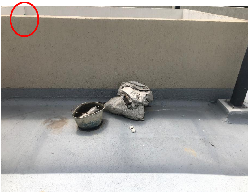
Foto 87. Residuos de obra y Sellar tubería
