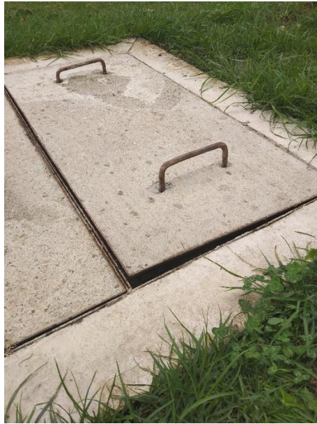
Foto 14. Tapas de inspección no cierran correctamente
