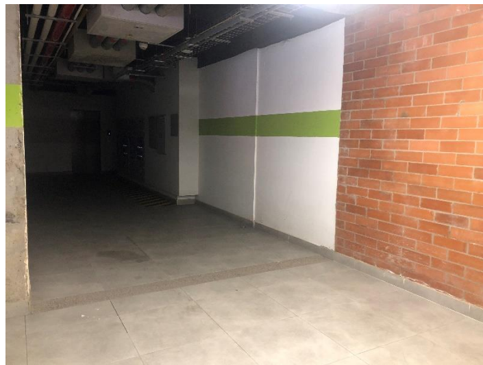
Foto 71. Torre 2 sin señalización de ubicación de planta
