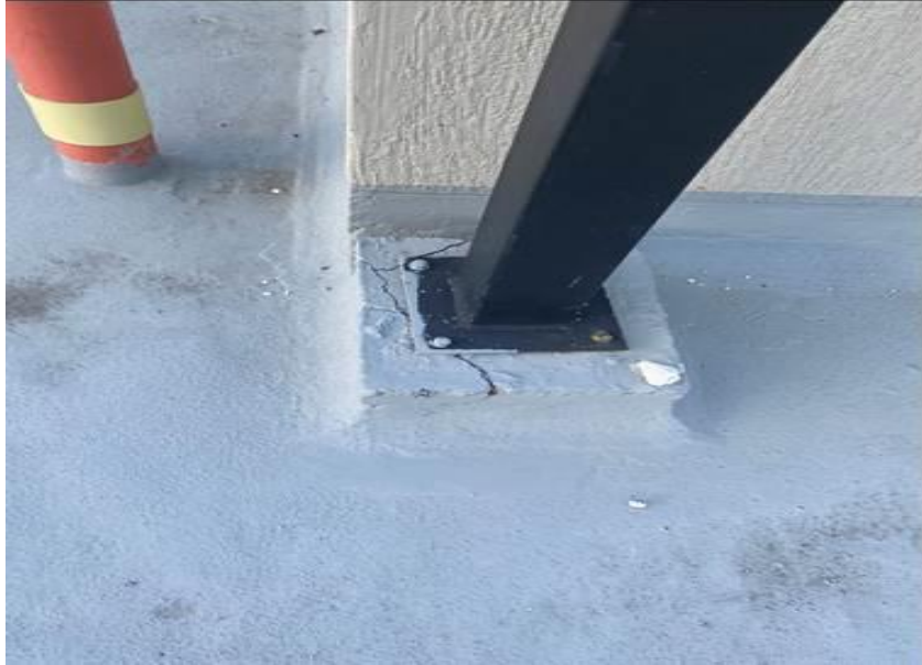
Foto 116 Pedestal de la cubierta marquesina fisurado
