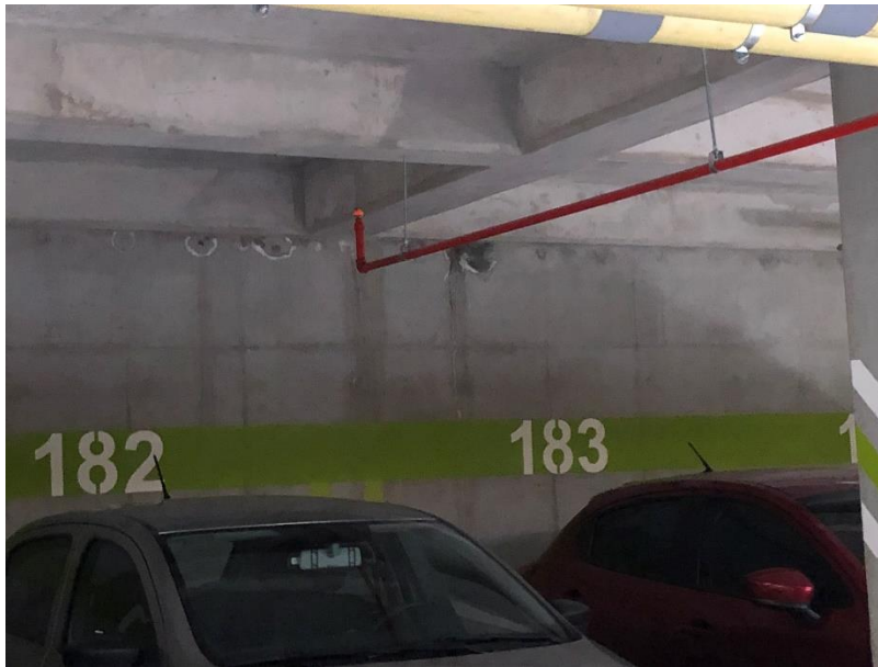
Foto 49. humedad parqueadero 182 y 183
