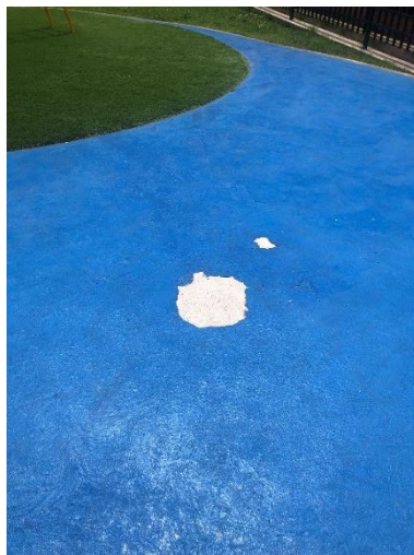
Foto 29. Levantamiento de acabado de piso
