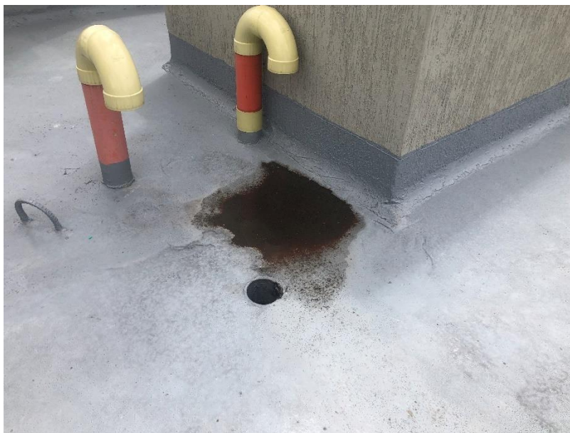
Foto 79. Sifones sin rejillas y empozamientos de agua
