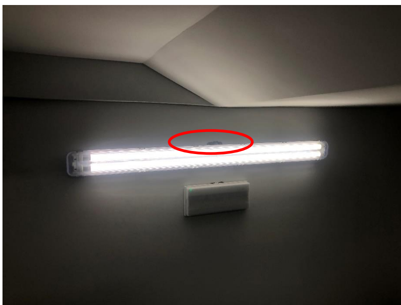
Foto 100. Rematar hueco en pared sobre lampara PLANTA 6
