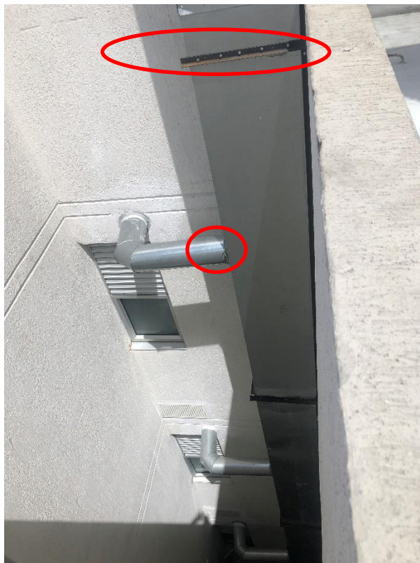
Foto 115. Verificar uniones de ducto y perfiles oxidados
