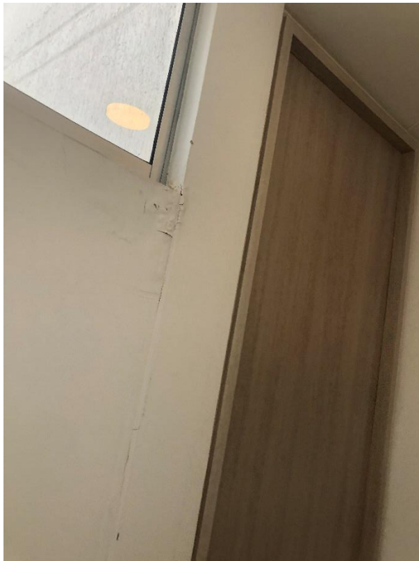
Foto 146. Fisura y humedad contra ventana P11
