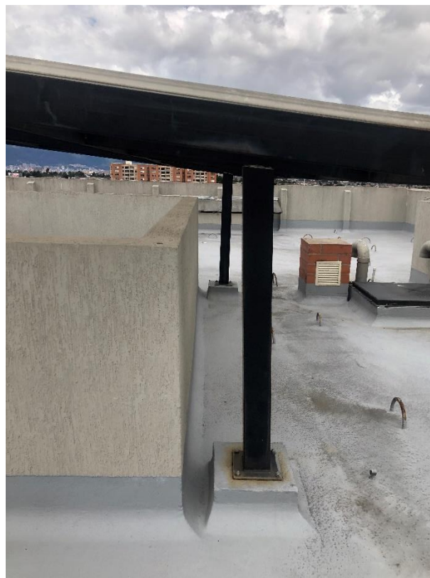
Foto 166. Oxido en parales de marquesina
