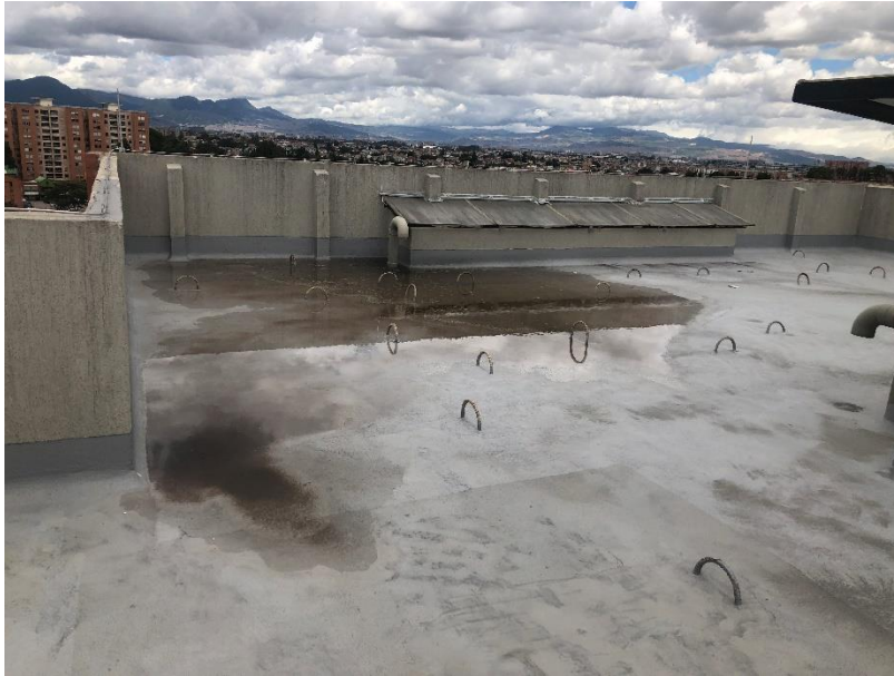
Foto 158. Empozamientos de agua en cubierta
