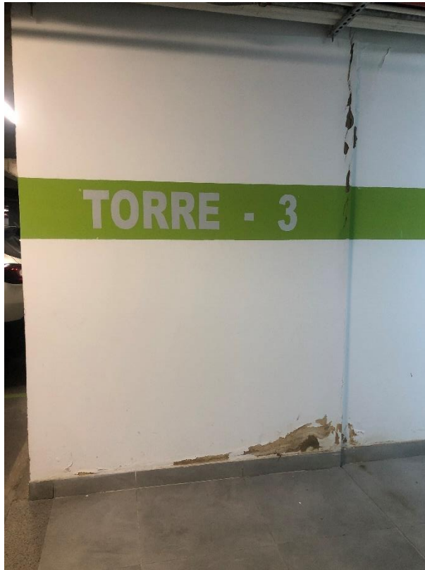
Foto 50. Humedad en muro del hall de la torre 3
