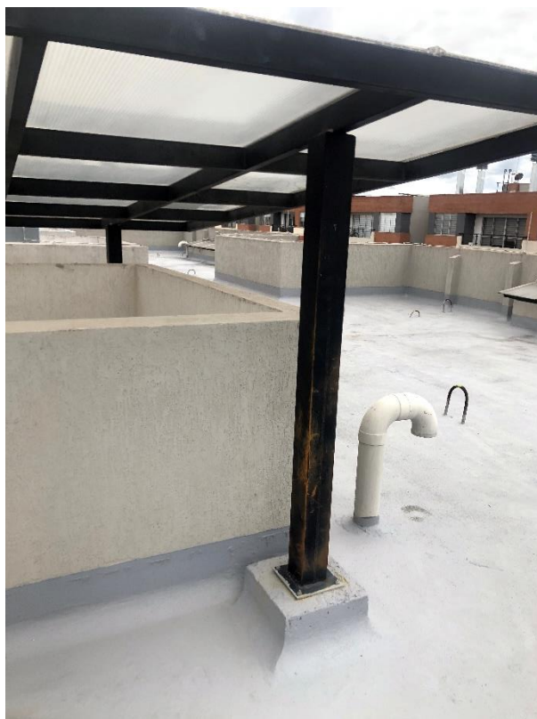
Foto 139. Oxido en parales de marquesina
