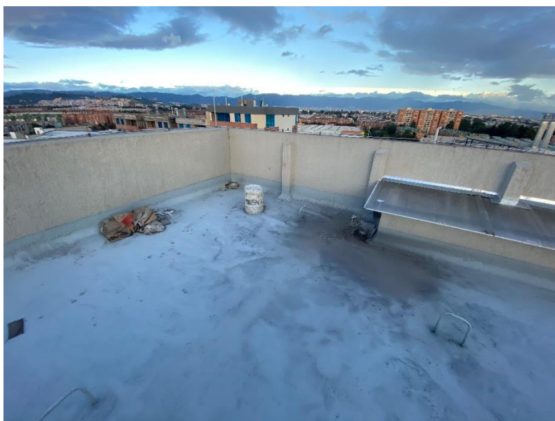
Foto 123. residuos de construcción en cubierta
