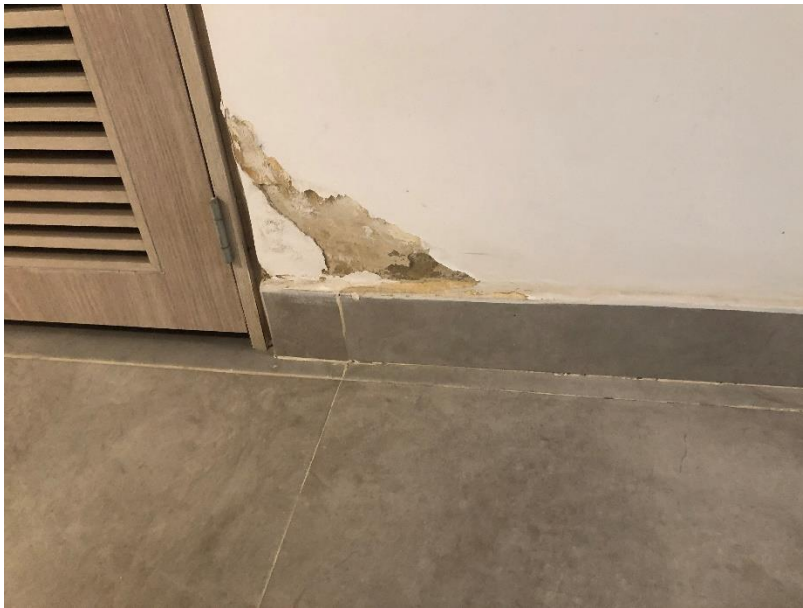
Foto 176. Humedad desde cuarto desde medidores 101-102
