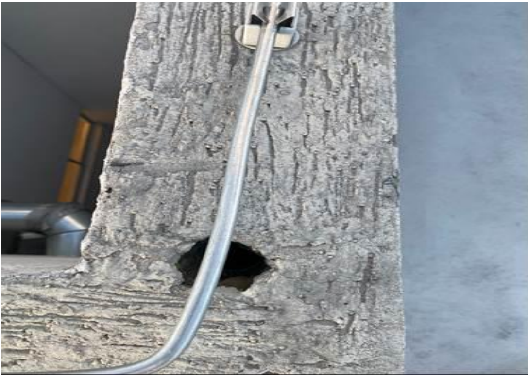
Foto 77 bajantes apantallamiento sin sellar
