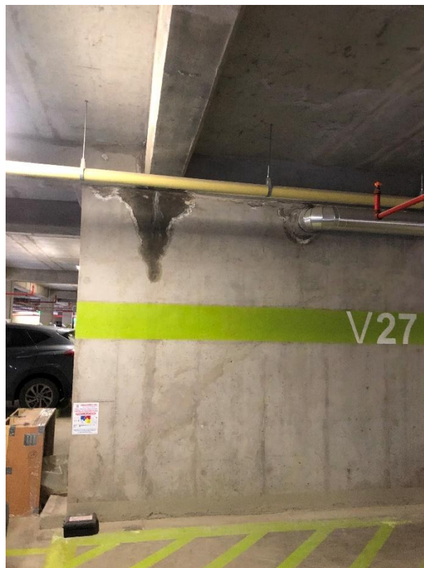
Foto 44. Humedad parqueadero V 27
