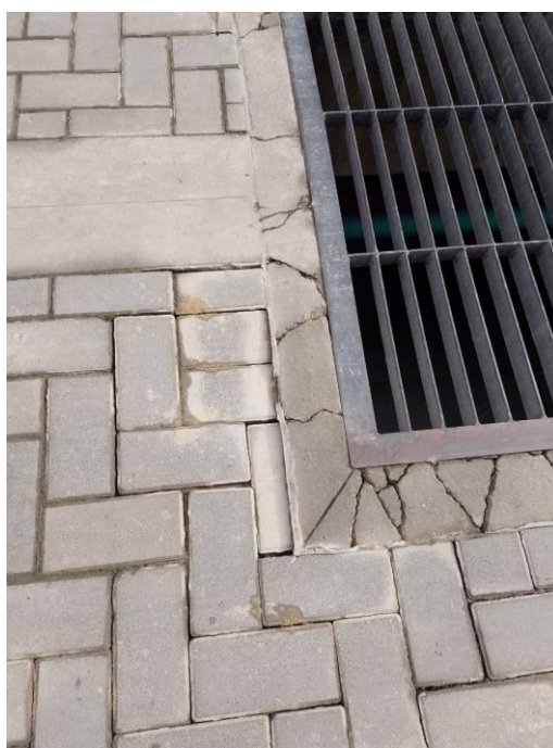
Foto 10. marco de las rejillas en circulación de parqueadero fisurado
