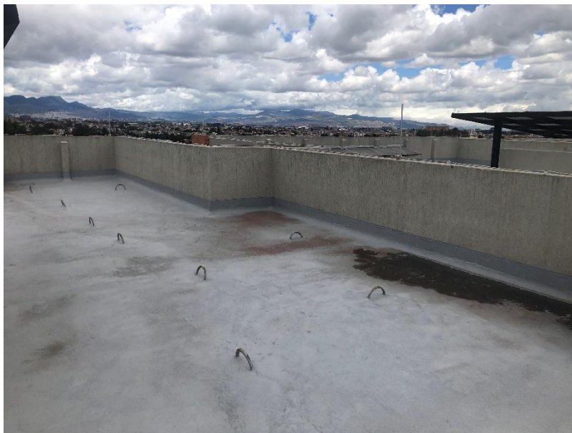
Foto 141. Empozamiento de agua
