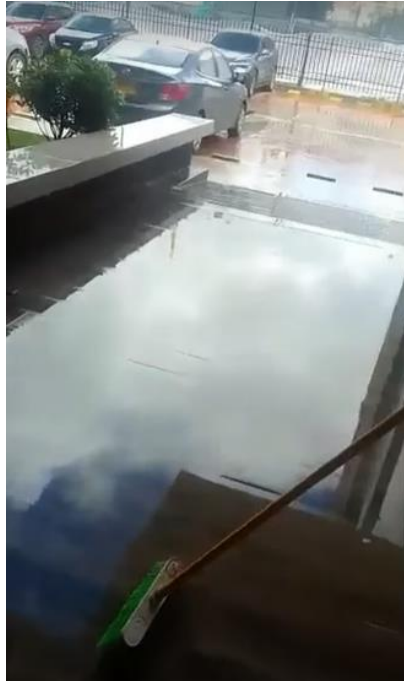
Foto 31. Zona de inundación frente al ascensor de zonas comunes
