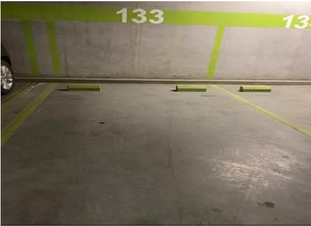
Foto 32 Fisura en placa de contrapiso parqueadero 133
