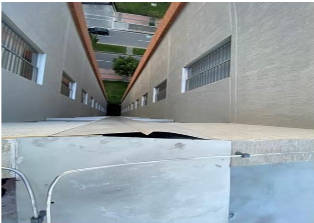
Foto 86 remate flashing afectado filtración de agua a torres
