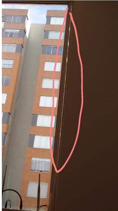
Foto 33. Ventana no cierra correctamente
