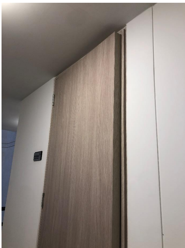
Foto 173. puerta caída no cierra Cuarto de medidores 301-302
