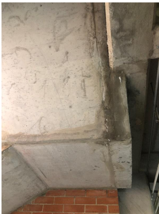
Foto 42. Humedad en la placa de techo de las escaleras frente a torre 2
