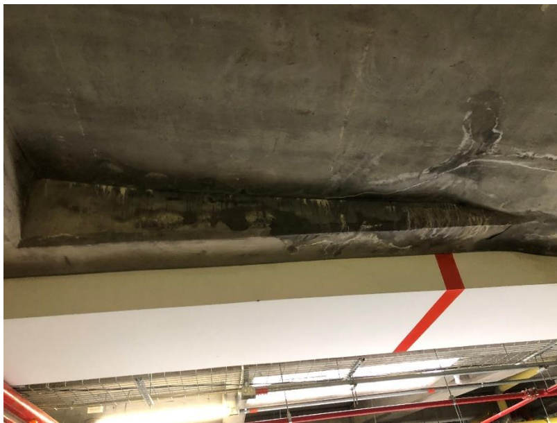
Foto 36. Humedad por filtración desde P1-rampa
