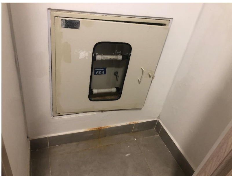
Foto 99. Mancha de oxido en pared bajo el gabinete de medidores
