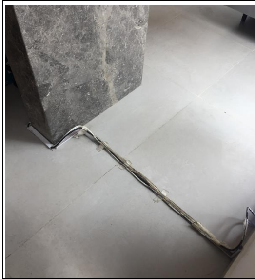
Fotografía 18. Red de citofonía. Fuente propia.
