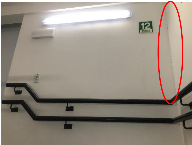
Foto 90. Fisuras en Punto fijo Escaleras
