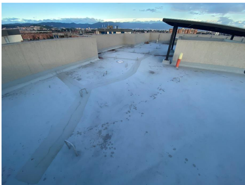
Foto 124. Resanes de impermeabilización
