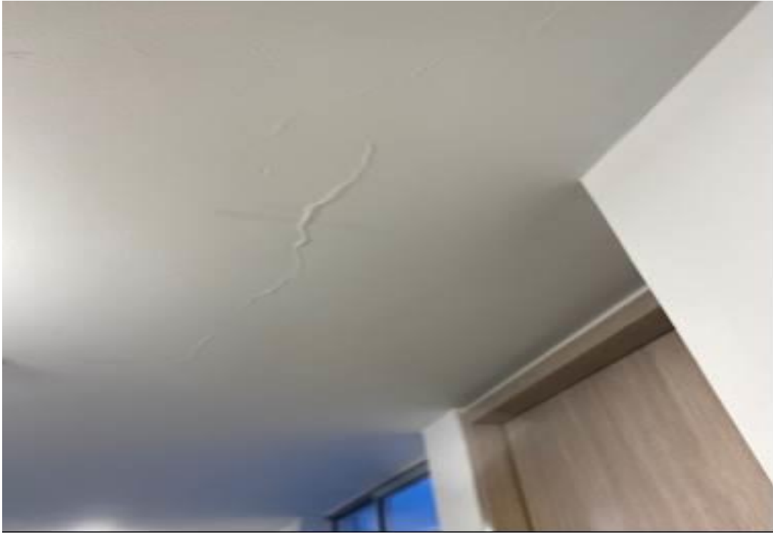
Foto 54 Fisuras bajo placa cubierta torres
