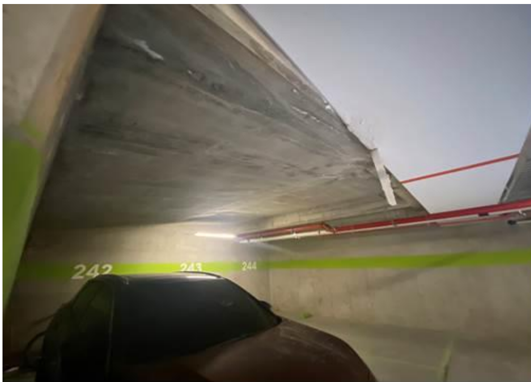
Foto 50 Fisuras rampa acceso parqueadero
