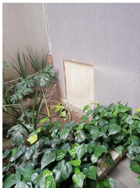
Foto 23. fachada sin rematar
