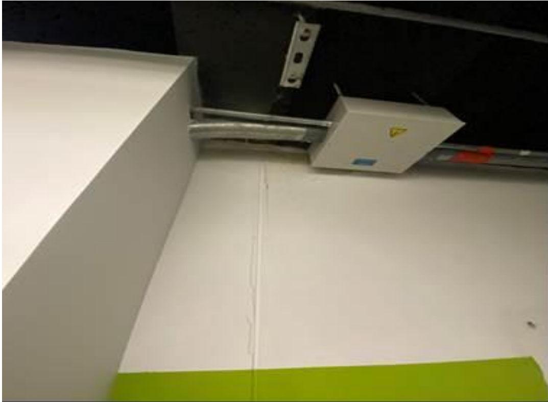
Foto 26 Filtraciones por fisura entre unión muro de contención sótano
