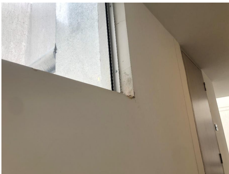
Foto 147. Fisuras y humedad contra ventana P10
