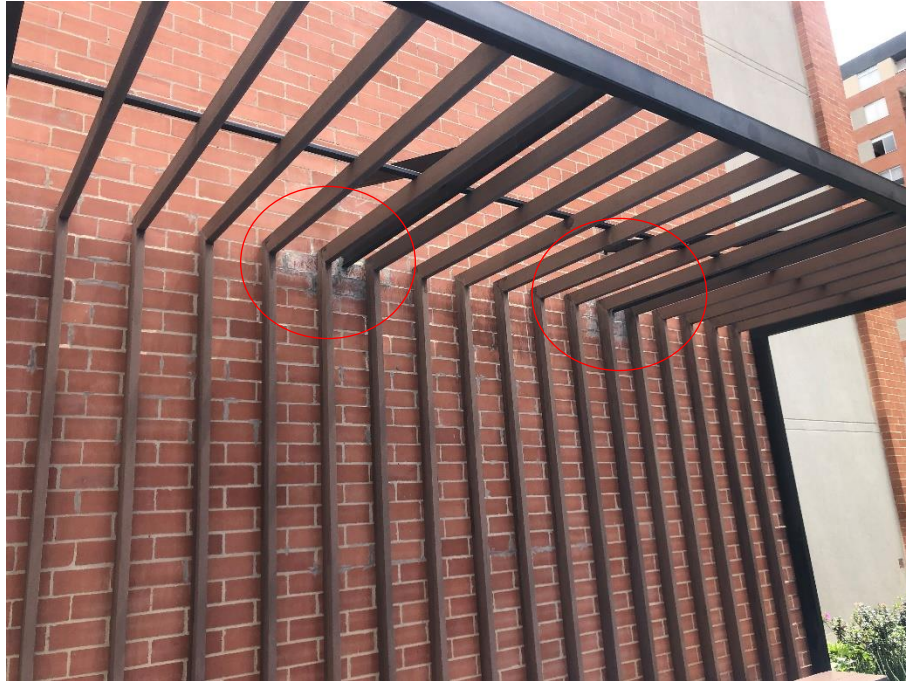
Foto 30. manchas de mortero en muro contra Cortasol
