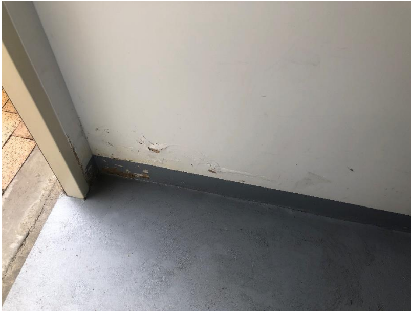
Foto 101. Humedad a la entrada de la torre
