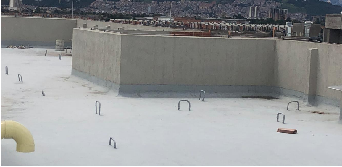
Foto 121. Empozamientos de agua en cubierta y restos de material de construcción
