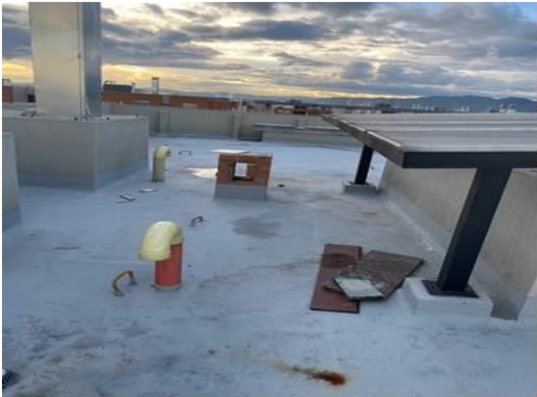
Foto 83 residuos de construcción en cubierta torres 2 y 3
