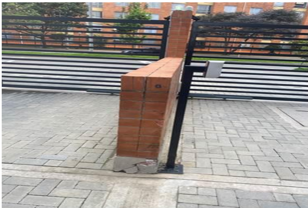
Foto 1 Fisura en murete ingreso
