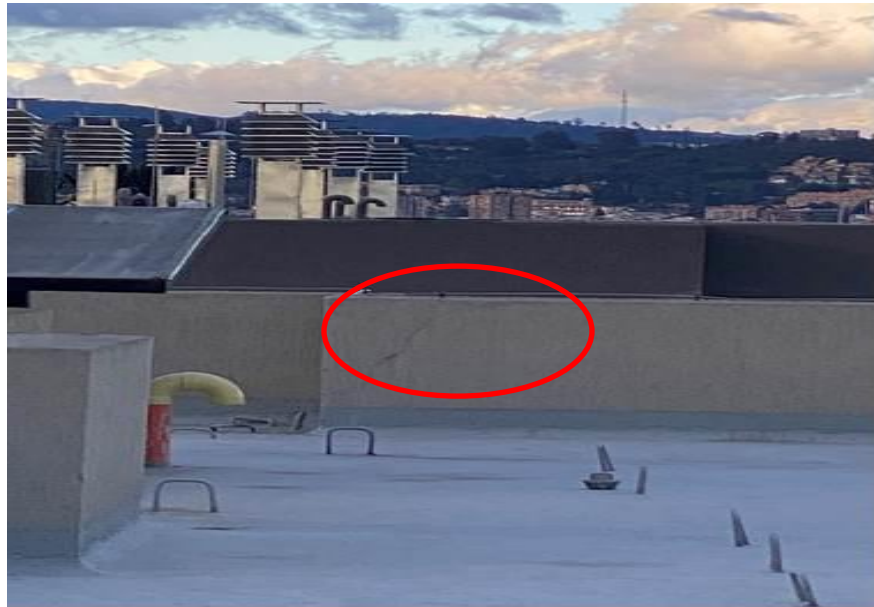
Foto 122. Fisura en antepecho
