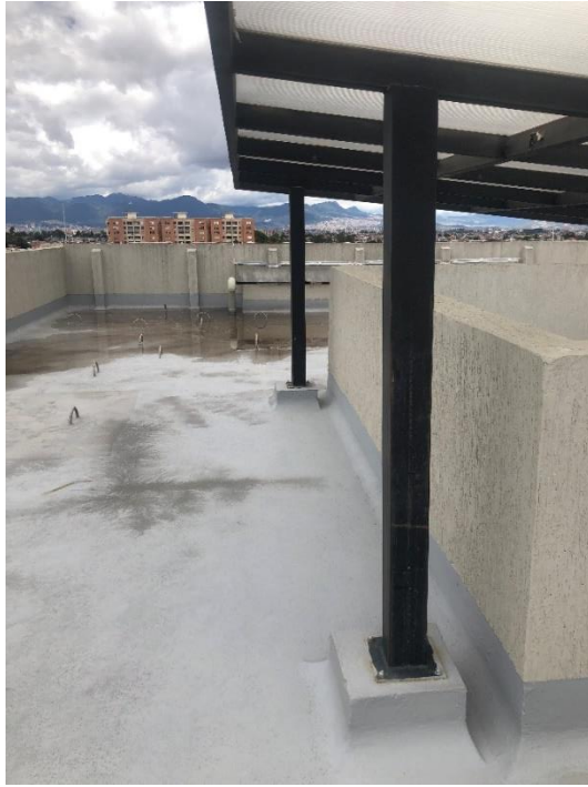
Foto 167. empozamiento de agua en cubierta
