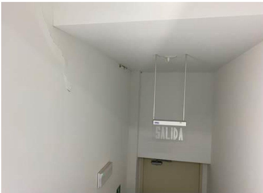
Foto 7 Fisuras en escalera emergencia torre 1 y 2 piso 12 a piso 1
