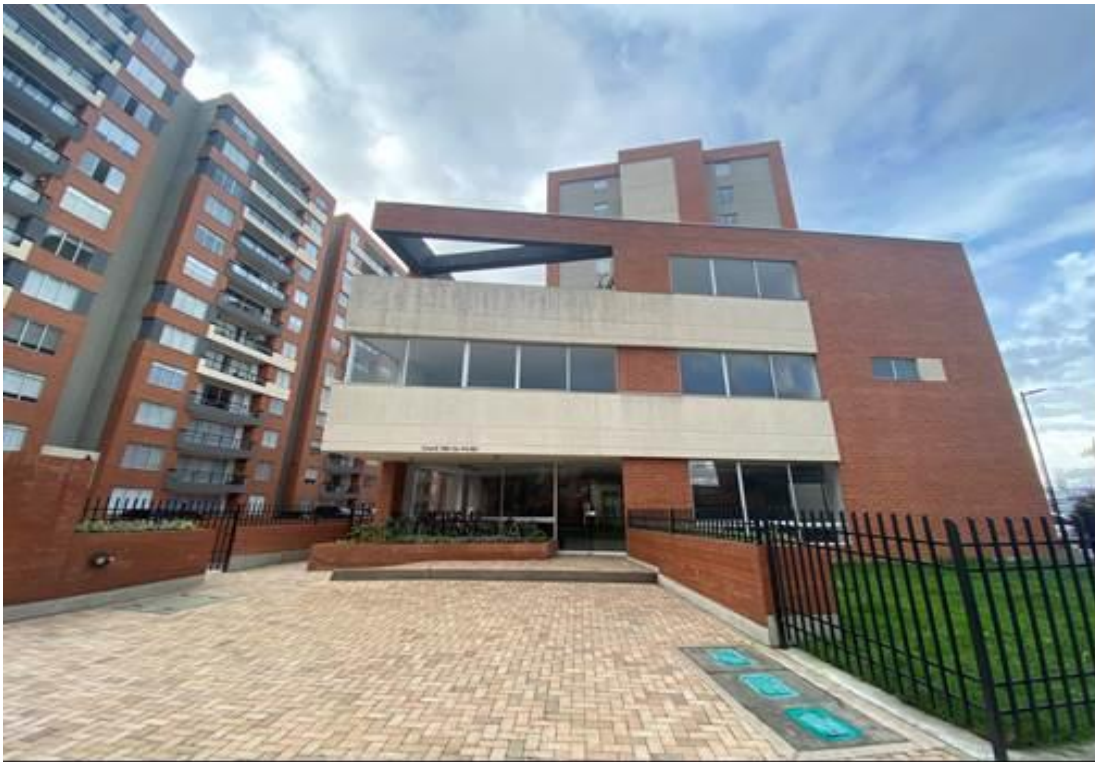
Foto 89 fachada portería manchada
