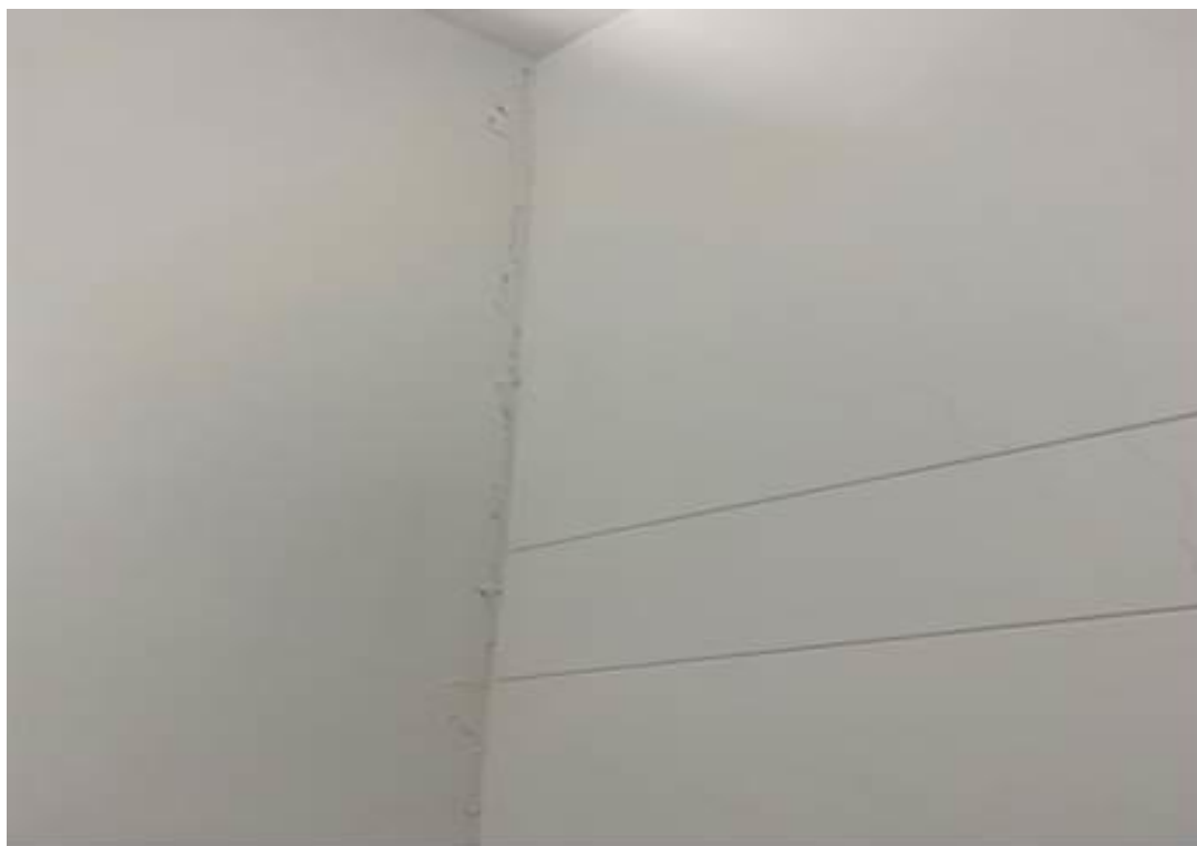
Foto 4 Fisuras en escalera emergencia torre 1 piso 12 a piso 1
