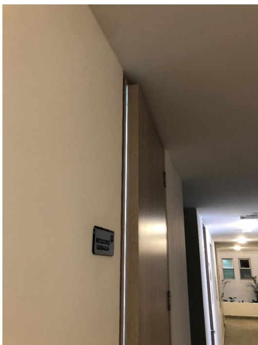
Foto 180. puerta 101-102cuarto de medidores no cierra
