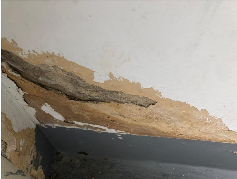
Foto 175. Humedad en ingreso a escaleras
