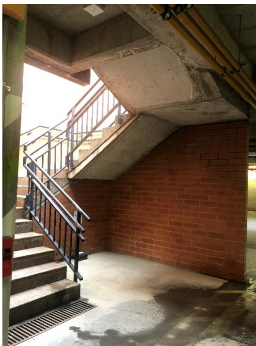
Foto 40 humedad por escalera cercana al parqueadero 215
