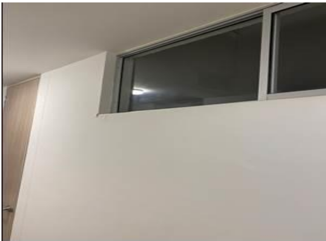
Foto 13 Fisuras en zona común torre 4 y 5 piso 12 a 2
