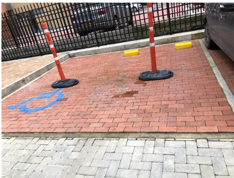
Foto 22. Parqueadero V21 sin demarcación
