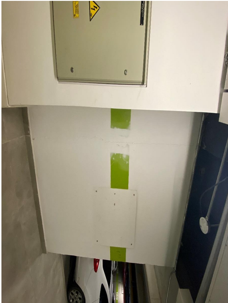
Foto 27 Filtraciones por fisura entre unión muro de contención sótano
