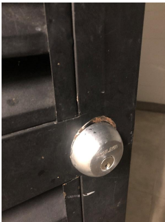
Foto 63. Cerradura suelta y oxido en puerta Torre 5 cuarto de basuras
