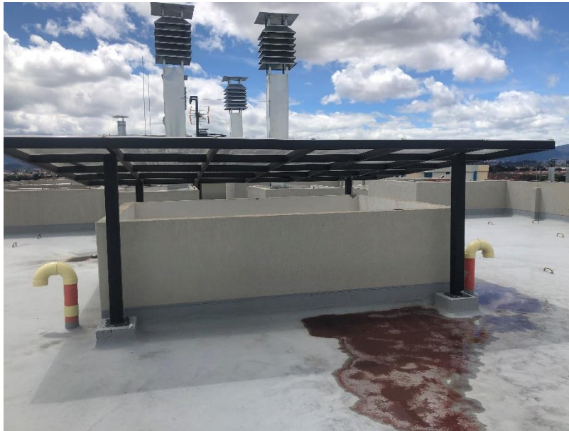
Foto 106. Empozamientos de agua en cubierta
