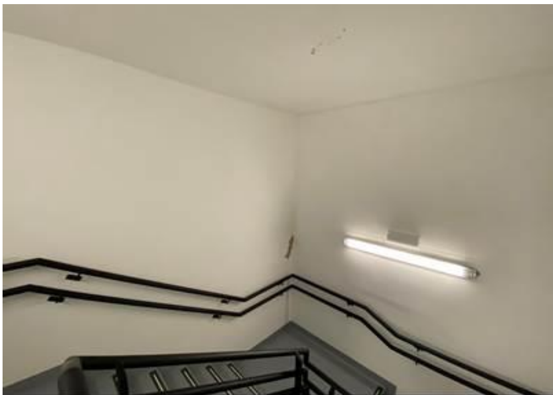
Foto 16 Fisuras en escalera emergencia torre 4 y 5 piso 12 a 2
