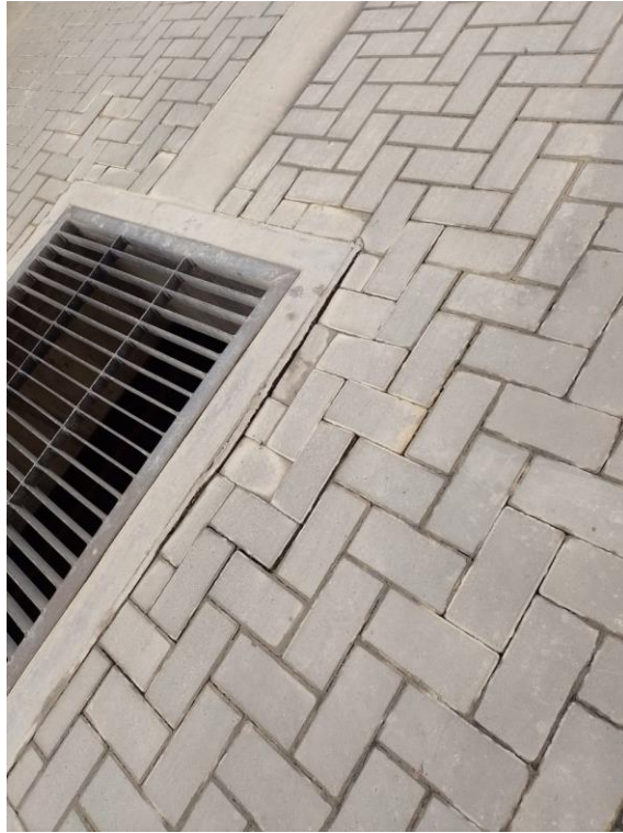
Foto 8. Adoquín circulación vehicular suelto
