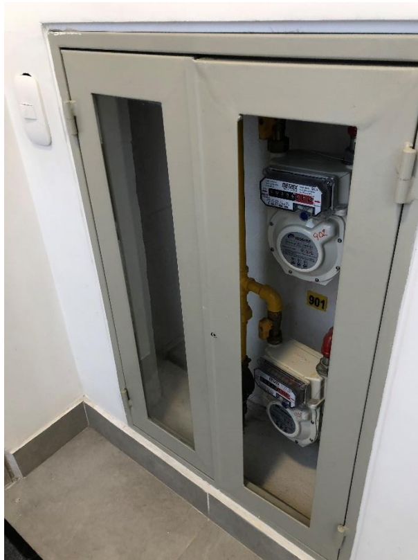
Foto 171. falta vidrio gabinete 901
