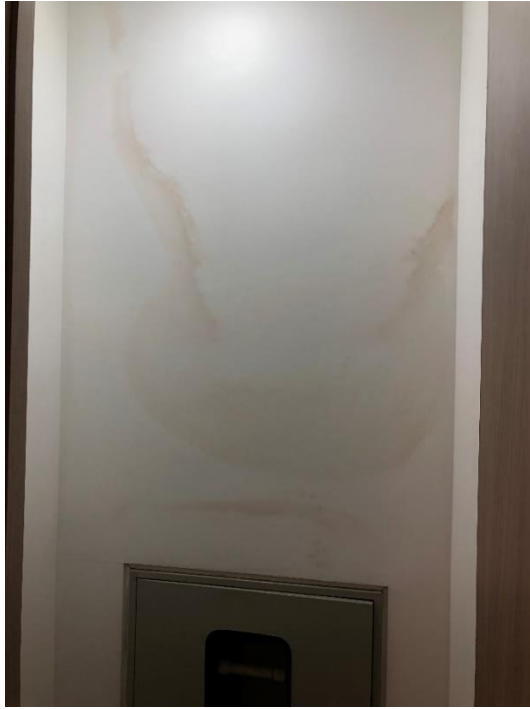
Foto 177. Humedad desde cuarto medidores 101-102
