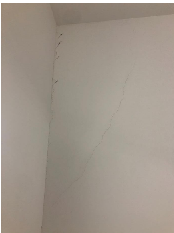
Foto 169. Fisuras generales en halls
