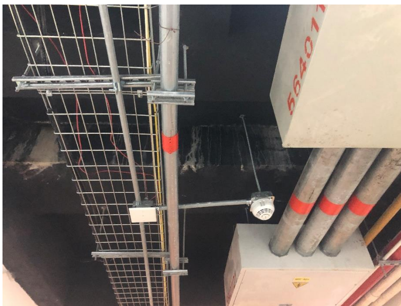
Foto 37 Humedad en la placa de techo en el hall de la torre 2
