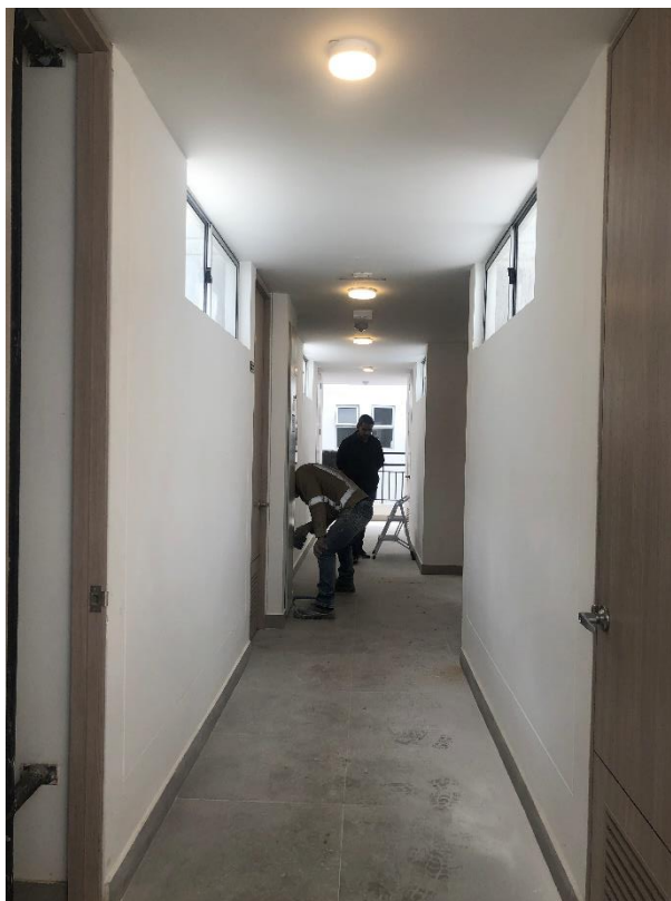
Foto 88. Fisuras en halls en proceso de reparación
