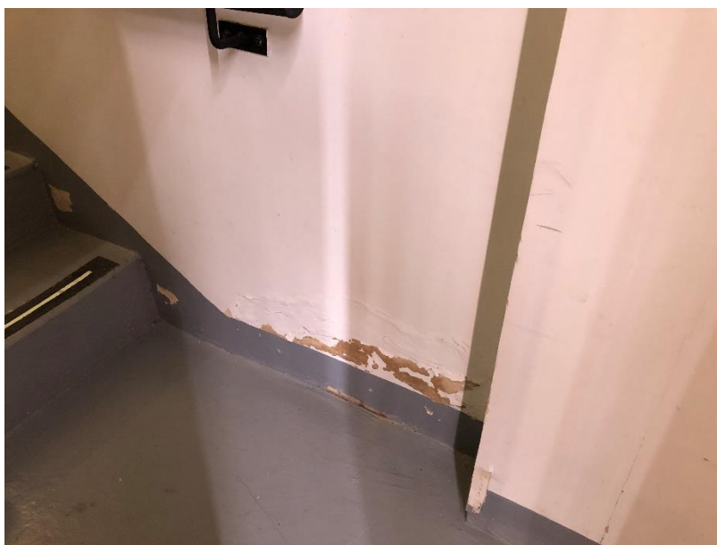
Foto 152. Humedad en pared salida de entrada de escaleras
