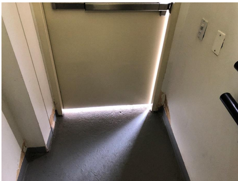
Foto 174. humedad en ingreso a escaleras
