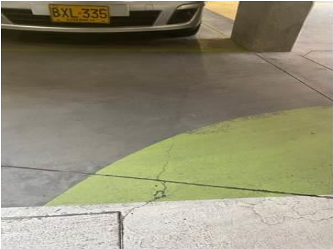
Foto 29 Fisura en placa de contrapiso frente parqueadero 241
