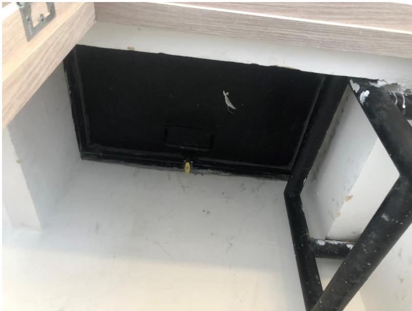
Foto 143. Manchas de pintura, filtraciones por claraboya
