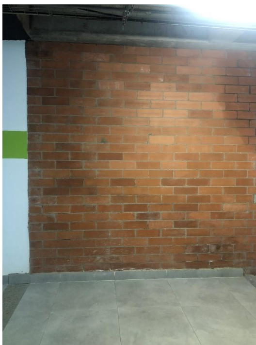
Foto 41. Humedad en muro hacia la torre 2, al lado de escaleras
