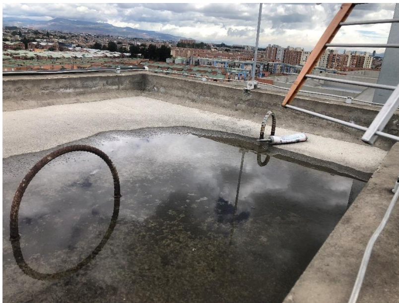
Foto 168. empozamiento de agua en cubierta de ascensor
