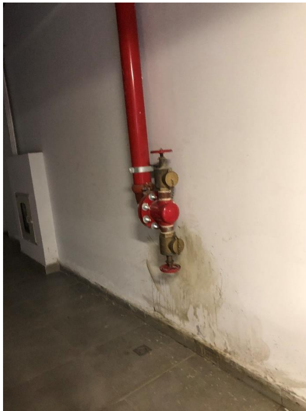
Foto 53. Humedad en muro frente a cuarto de bombas
