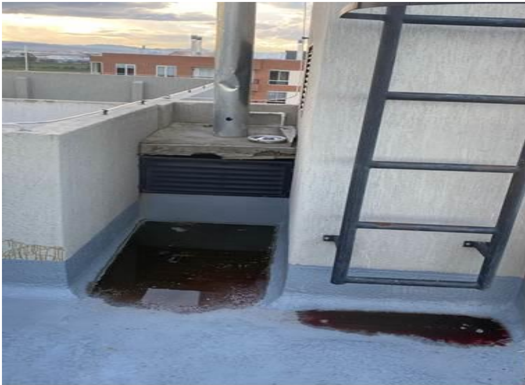
Foto 80 Empozamiento torre 1 y ducto sin rematar
