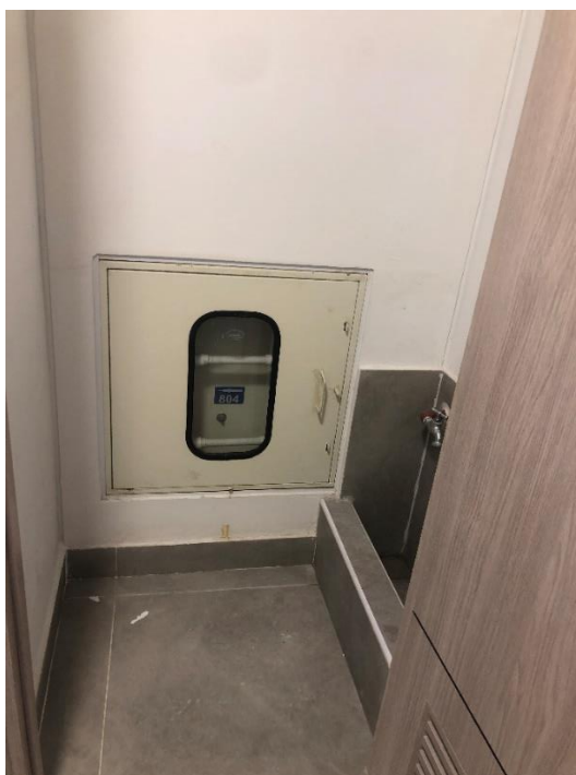
Foto 97. Mancha de oxido en pared bajo el gabinete de medidores
