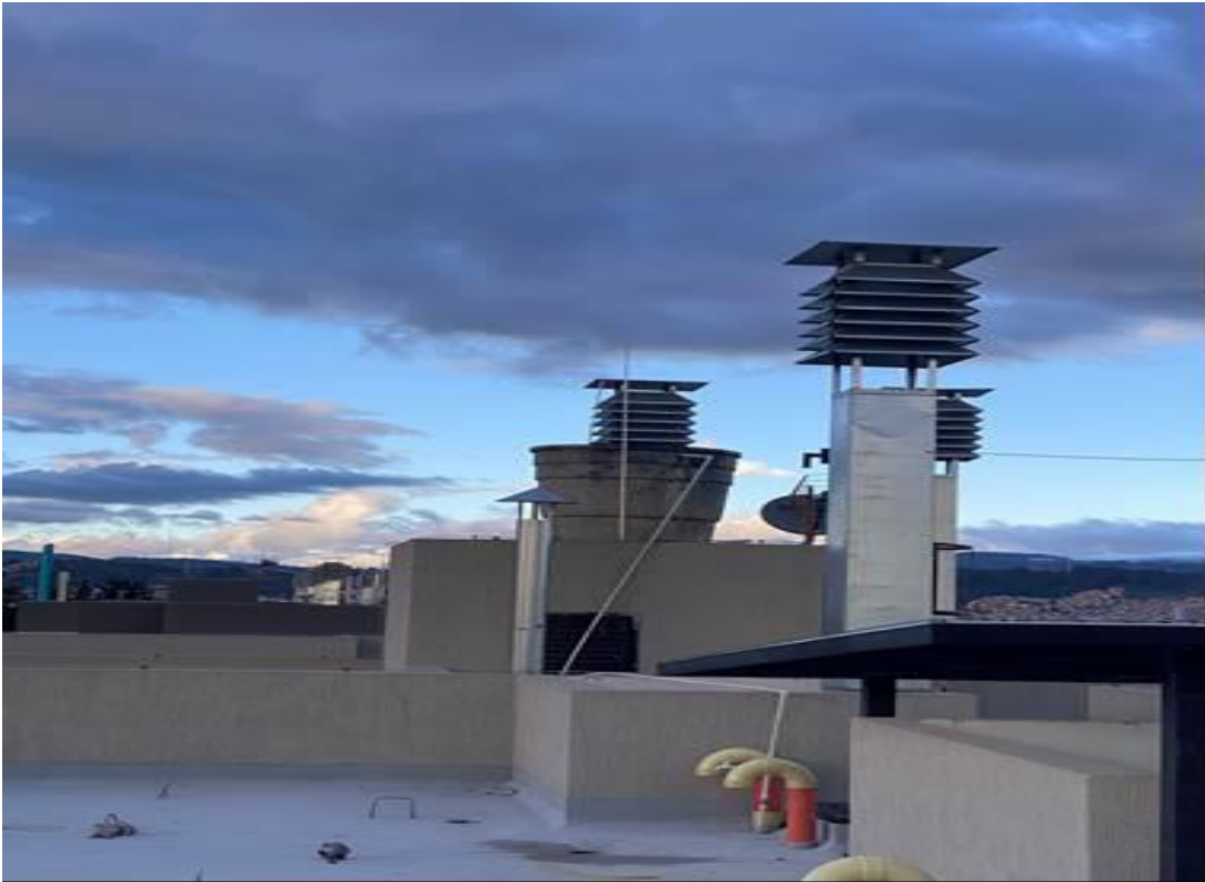
Foto 57 Tanque de agua cubierta ascensor torre 3
