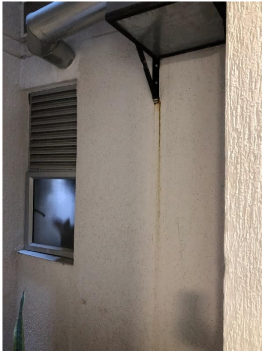
Foto 154. machas de oxido
