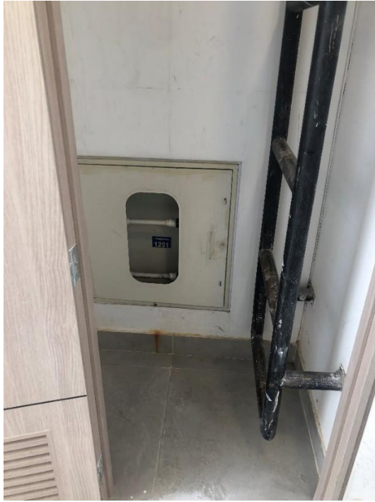
Foto 85. Manchas de oxido
