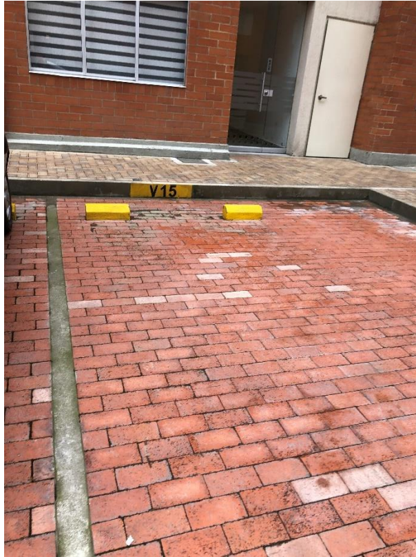
Foto 21. El parqueadero V-15 sin señalización PMR
