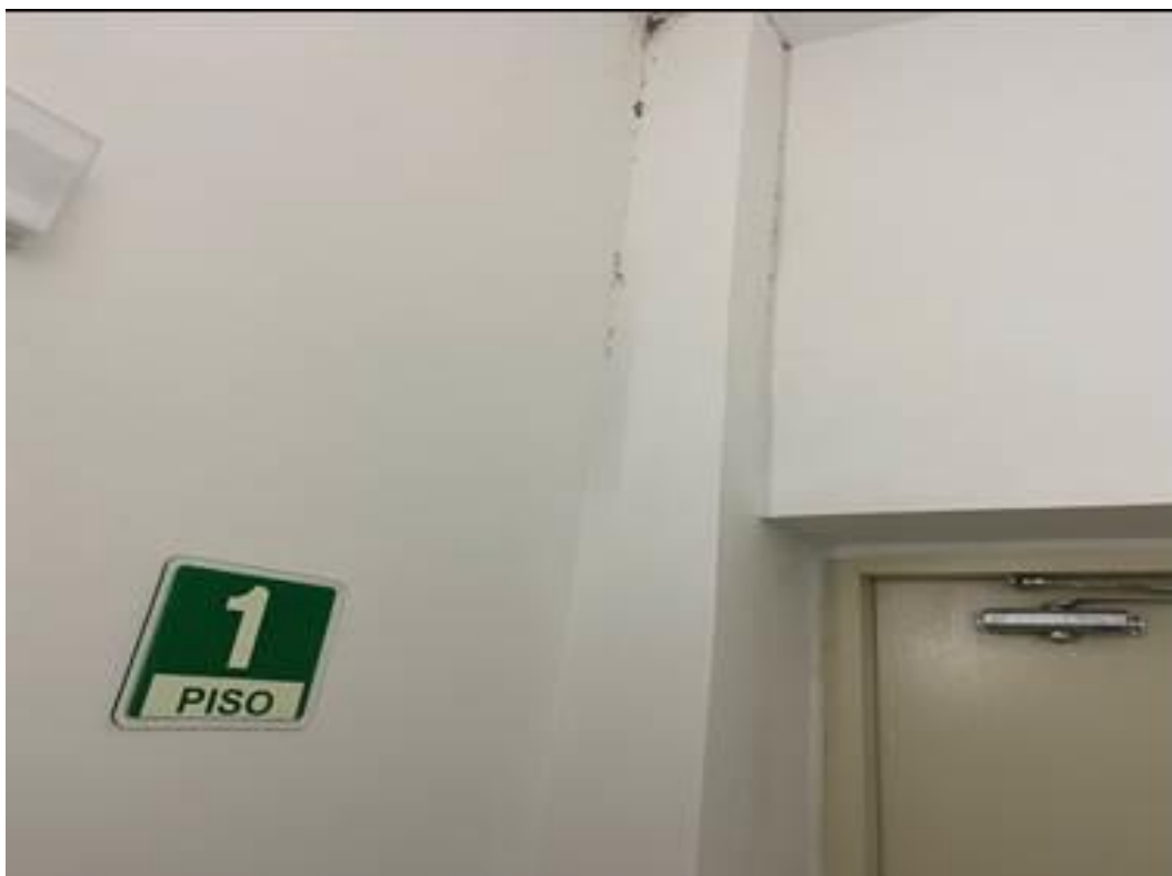
Foto 10 Fisuras en escalera emergencia torre 2 piso 1
