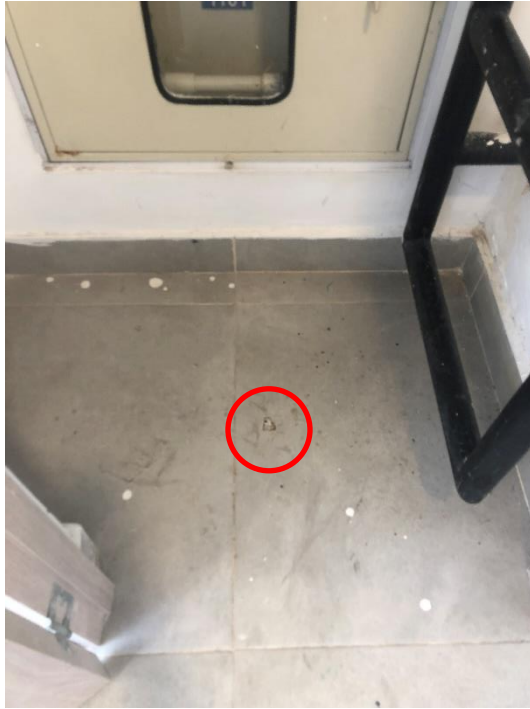
Foto 144. manchas de pintura y piso desportillado
