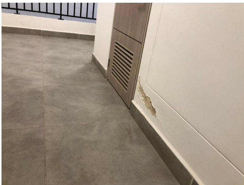
Foto 151. pared con pintura levantada piso 3
