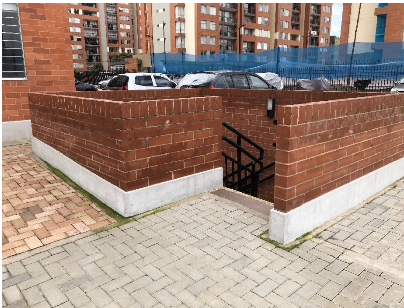
Foto 1. Humedad en los muros de la escalera al lado del parqueadero V-22
