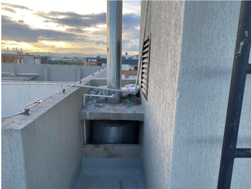
Foto 125. Falta rejilla y retirar escombros
