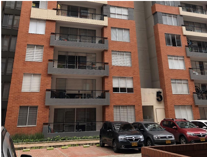
Foto 182. Manchas negra y deterioro muro superior al ingreso
