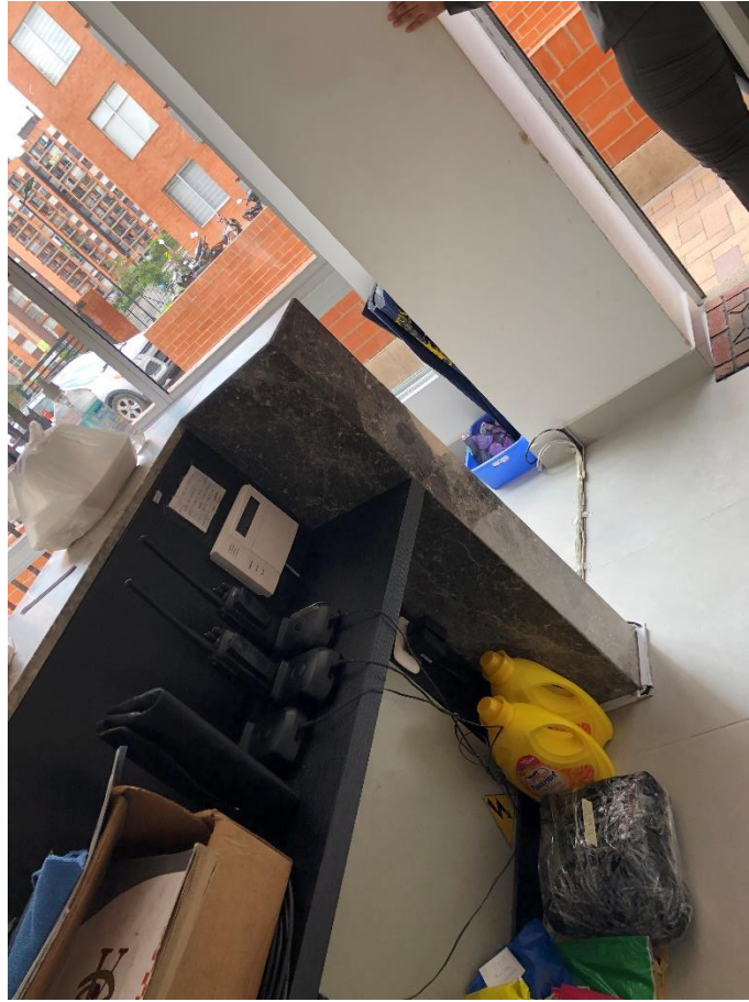
Foto 25. cableado sin protección y/o canalización adecuada en el piso
