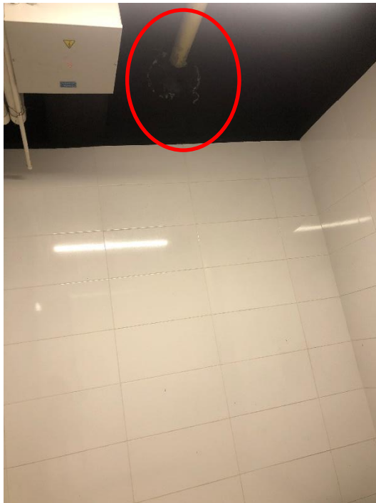
Foto 62. Humedad al contorno de la tubería en cuarto de basuras torre 5
