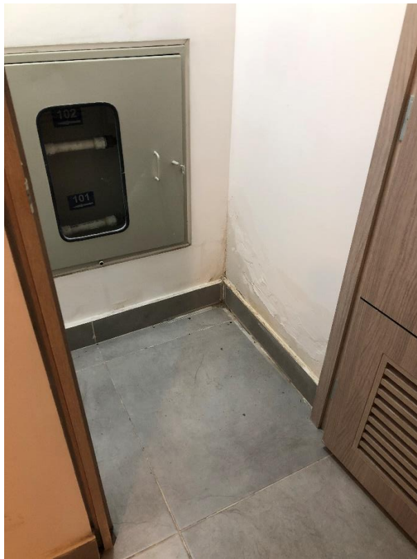
Foto 178. Humedad cuarto medidores 101-102
