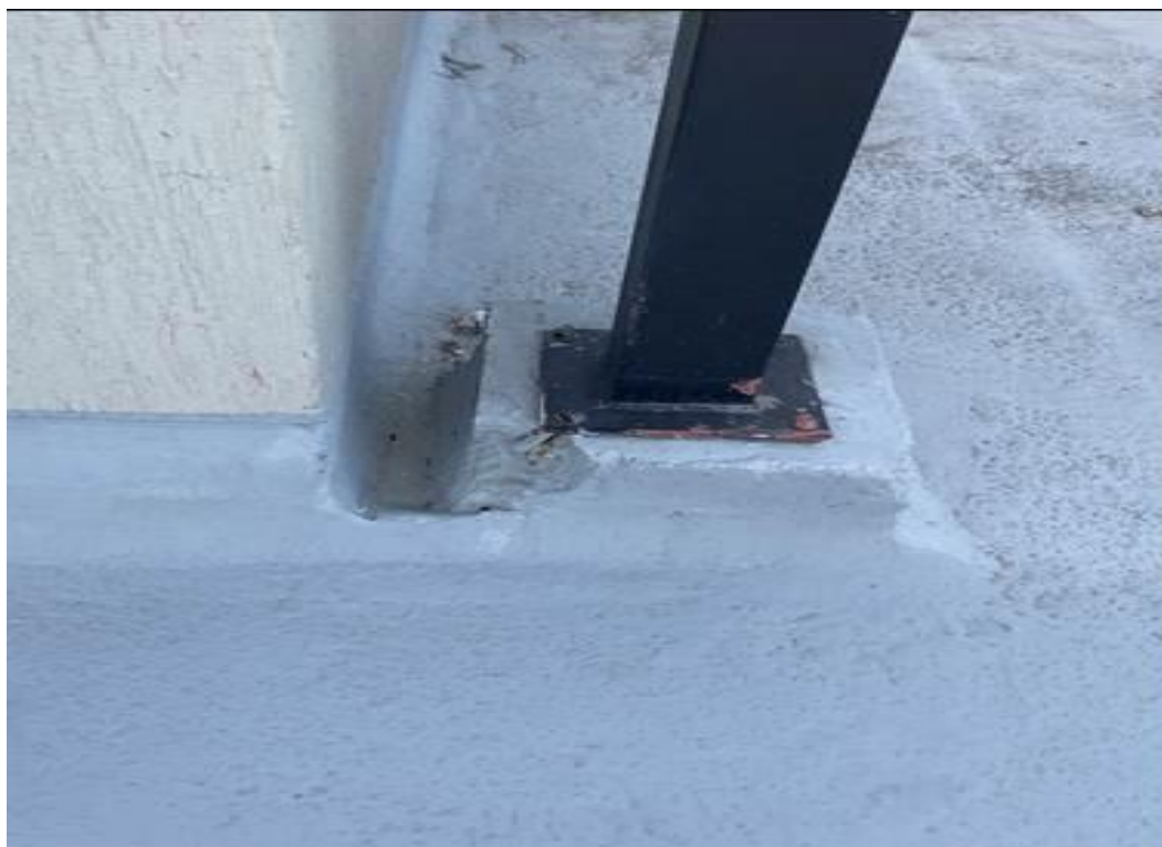
Foto 60 pedestal cubierta liviana torre 2 con anclaje mal ejecutado
