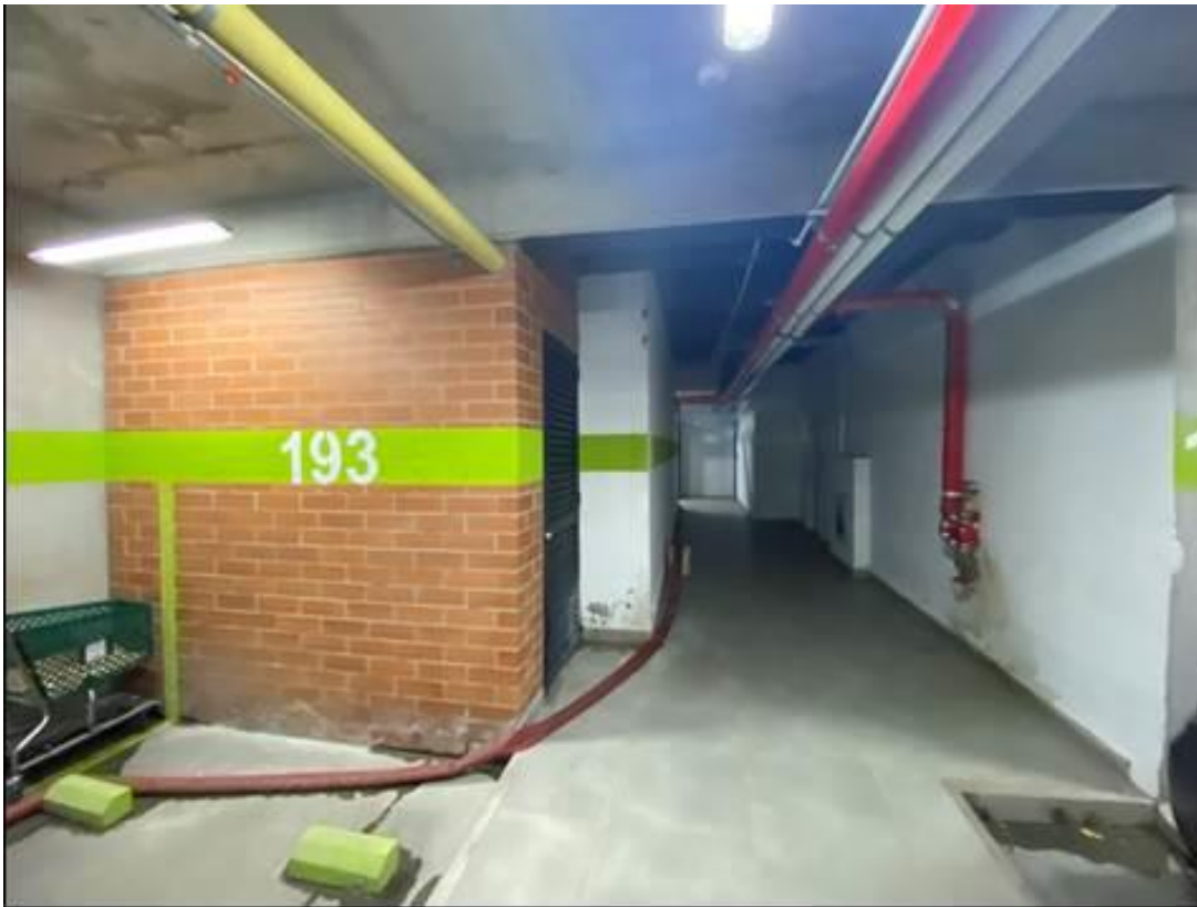
Foto 53 Ingreso de agua placa sobre parqueadero 193
