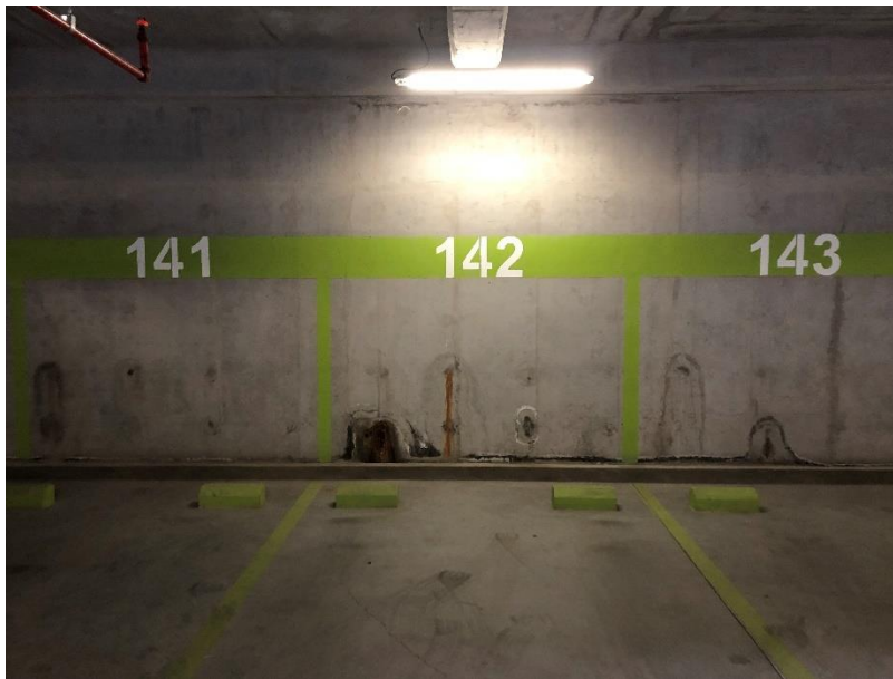
Foto 43. Humedad muro de parqueaderos 141,142 y 143
