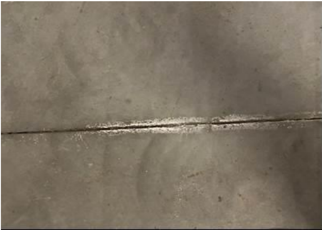
Foto 41 Ingreso de agua por dilataciones de piso sin sello
