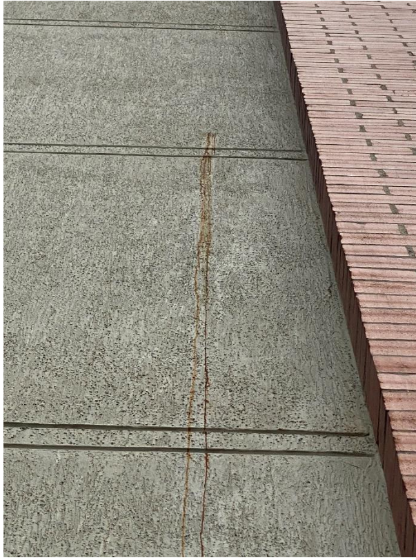
Foto 105. verificar mancha de oxido en fachada lateral de la torre 1
