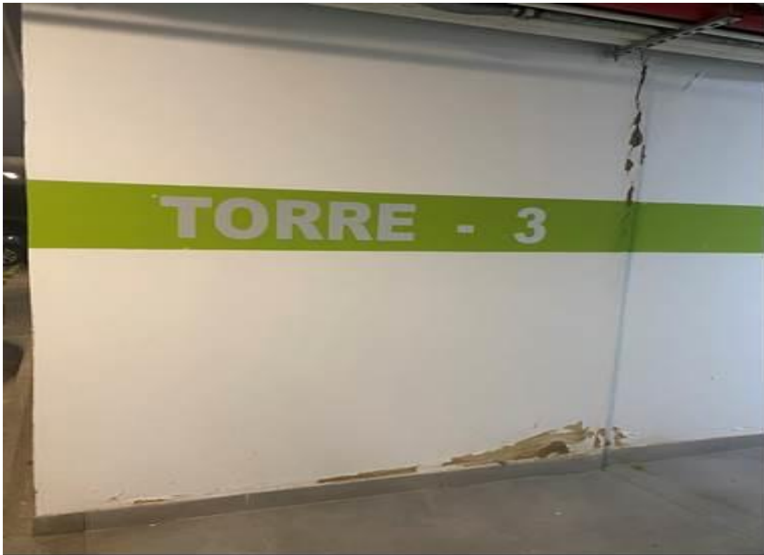
Foto 22 Filtraciones por fisura entre unión muro de contención sótano
