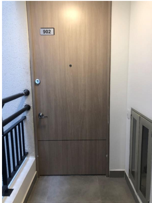
Foto 93. Manchas de pintura en marcos
