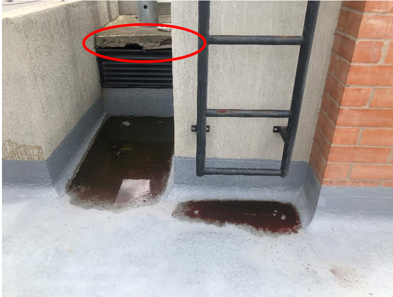
Foto 80. empozamiento de agua y mal acabado contra rejillas
