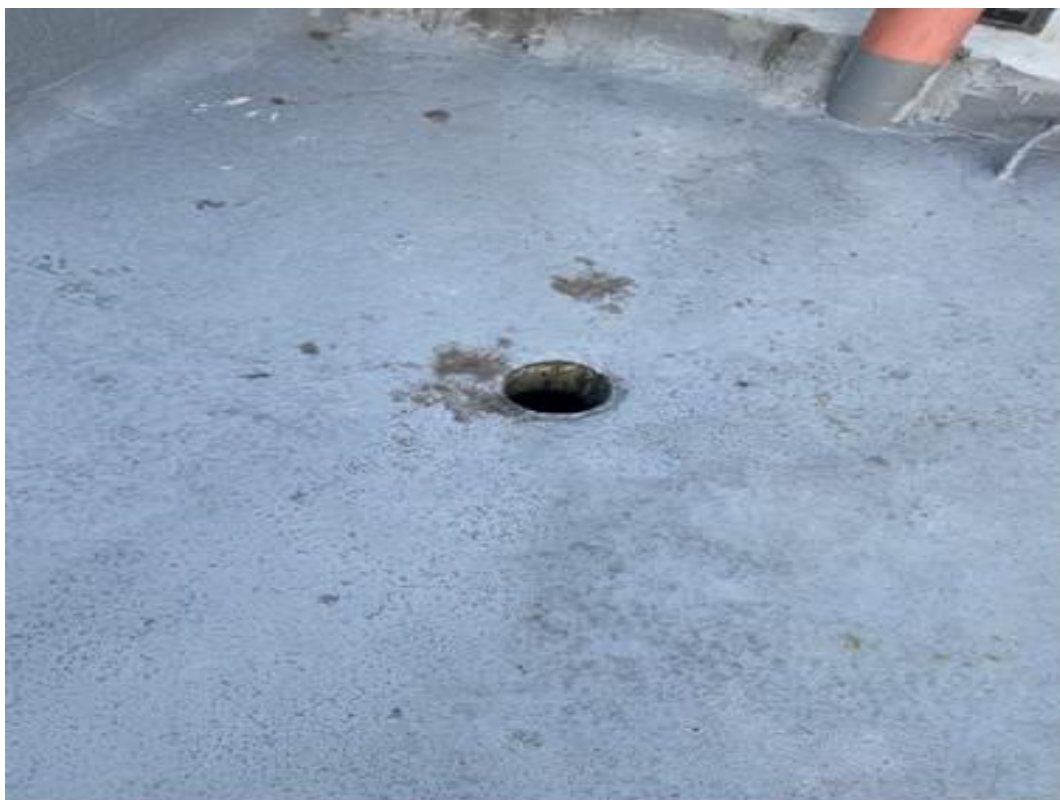
Foto 66 Cubierta torres sin rejillas en tragantes
