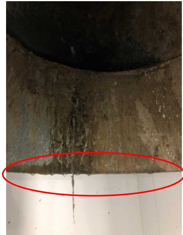
Foto 57. Filtración por ducto de basuras Torre 2
