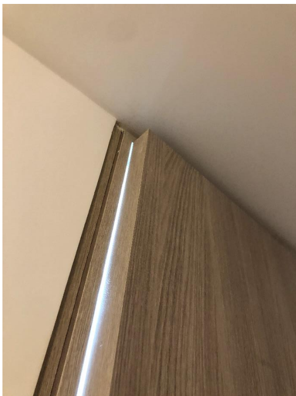
Foto 179. puerta 101-102cuarto de medidores no cierra
