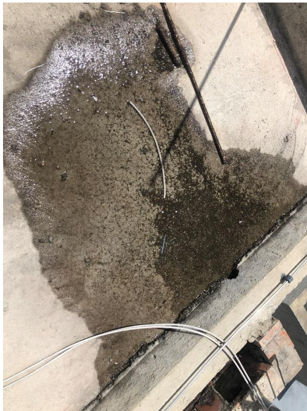
Foto 81. Cubierta de ascensor con empozamiento de agua
