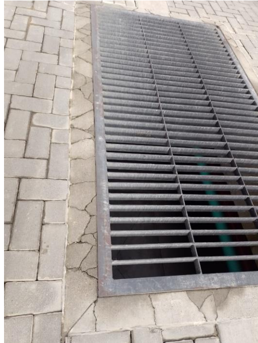
Foto 11. marco de las rejillas en circulación de parqueadero fisurado
