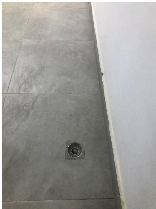
Foto 69. Sifones sin rejillas
