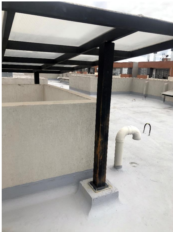
Foto 139. Oxido en parales de marquesina
