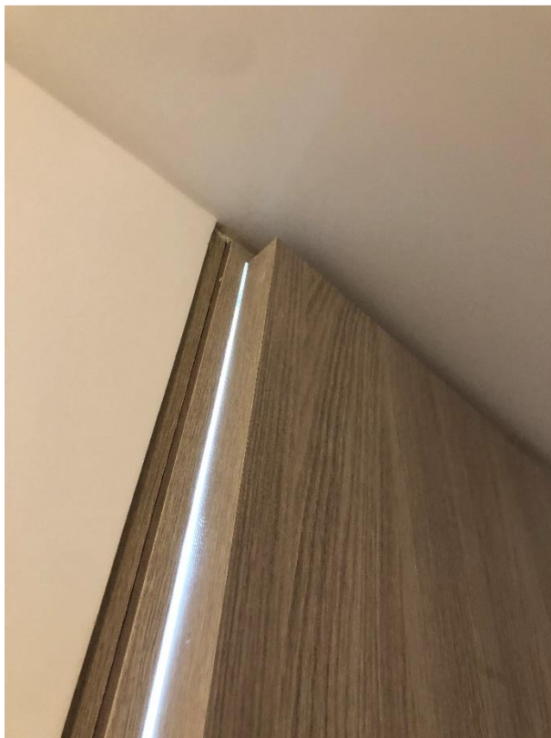
Foto 179. puerta 101-102cuarto de medidores no cierra
