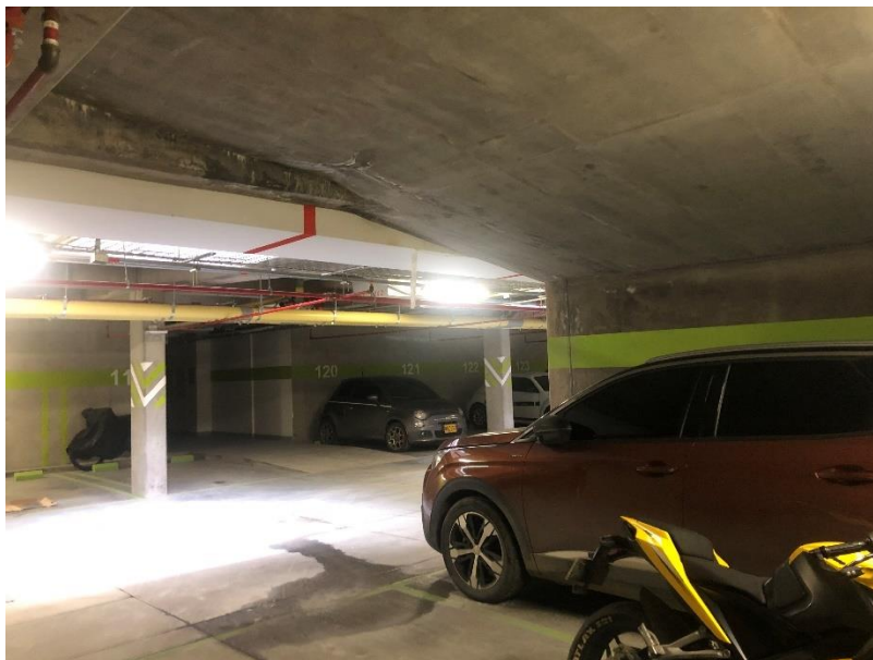
Foto 35. Humedad parqueaderos 242-243 y 244
