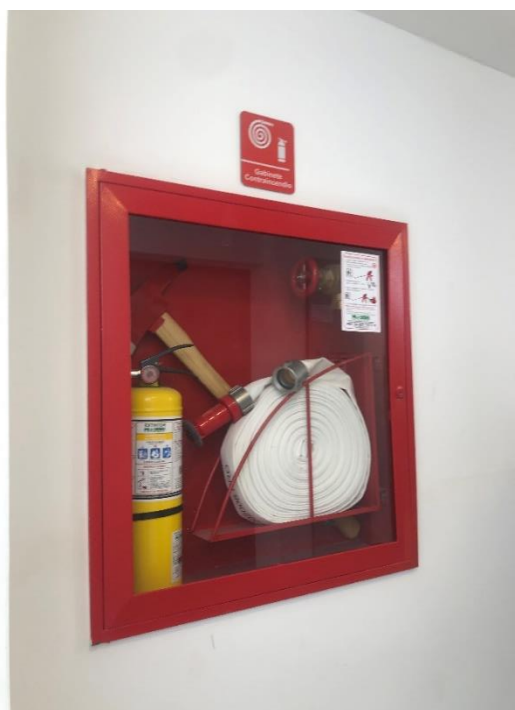
Foto 89. Gabinetes red contra incendios
