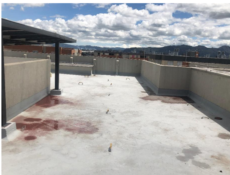
Foto 109. Empozamientos de gua
