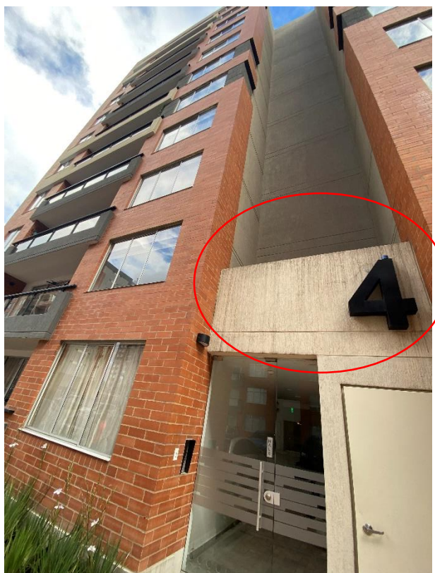
Foto 157. manchas negras y deterioro de pintura
