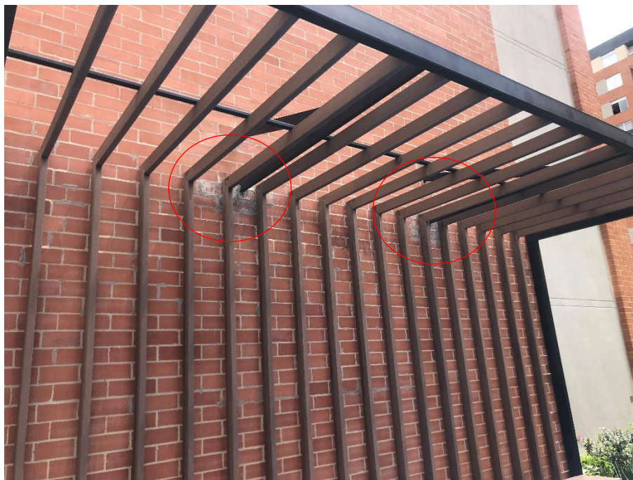
Foto 30. manchas de mortero en muro contra Cortasol
