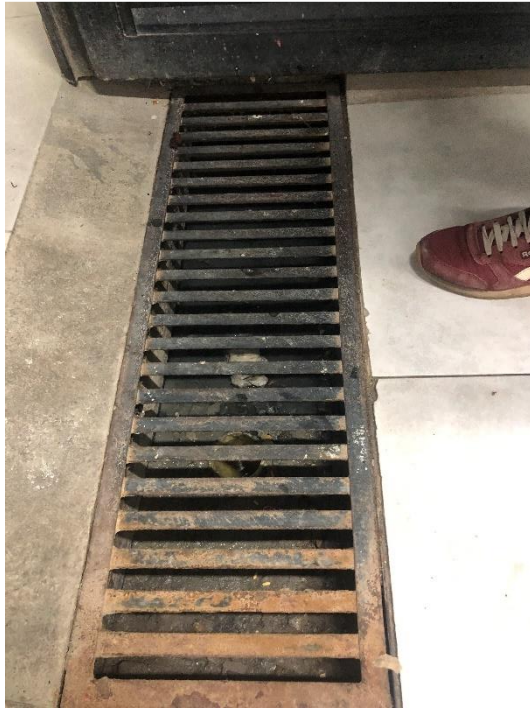
Foto 54. Sifón sin rejilla cuarto de basura Torre 1
