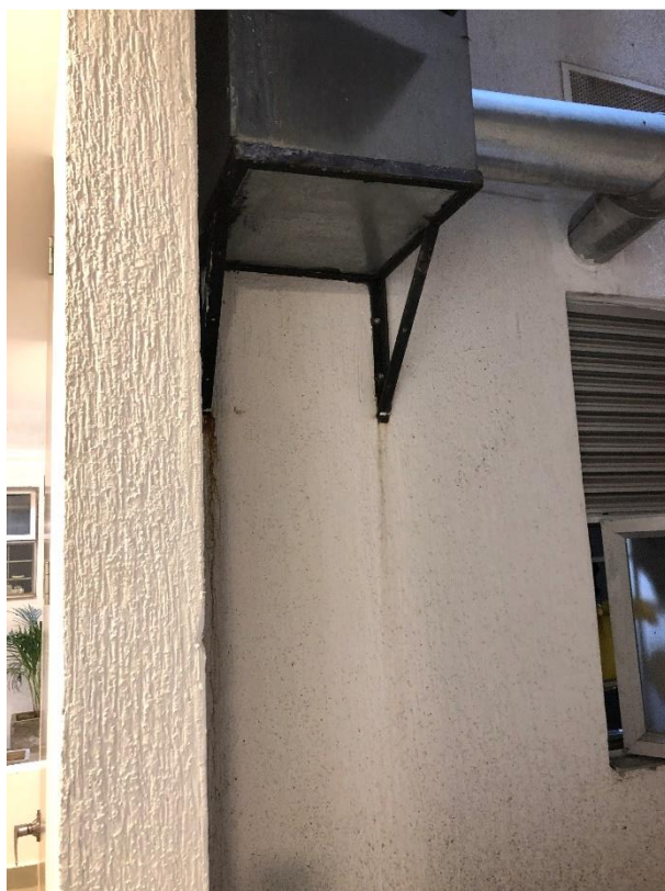
Foto 153. machas de oxido
