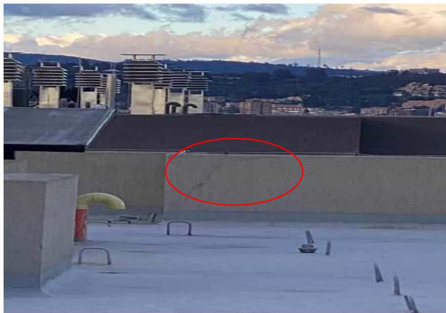
Foto 122. Fisura en antepecho
