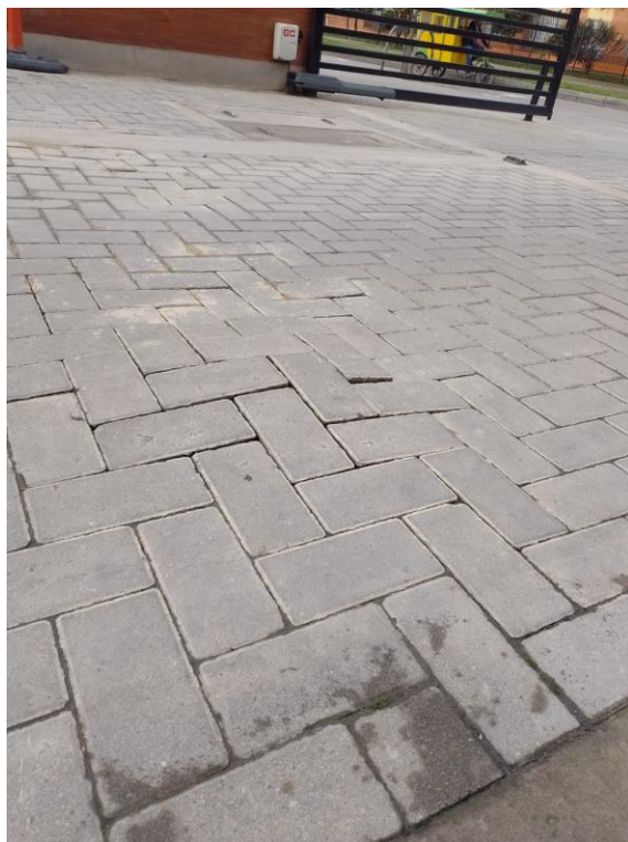
Foto 6. Adoquín circulación vehicular suelto
