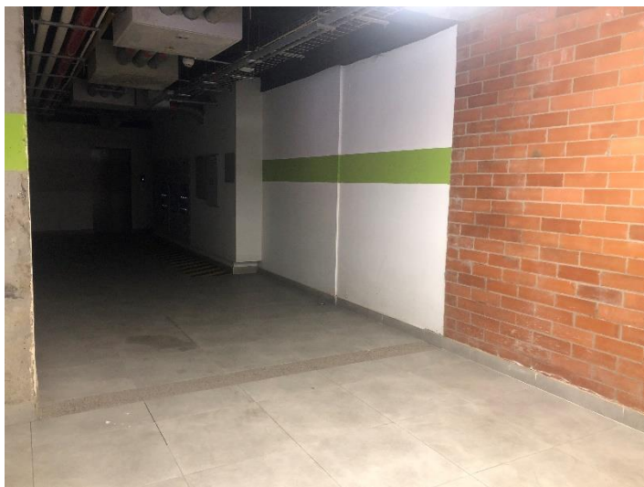
Foto 71. Torre 2 sin señalización de ubicación de planta
