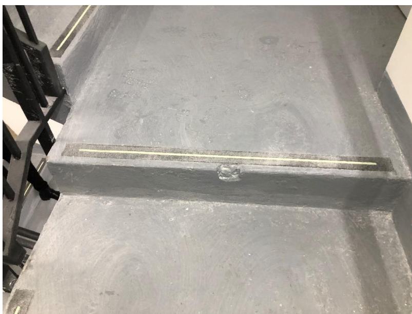
Foto 129. Escalón desportillado P11
