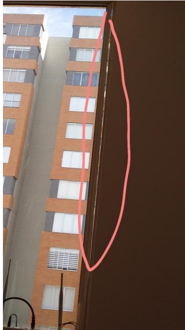
Foto 33. Ventana no cierra correctamente
