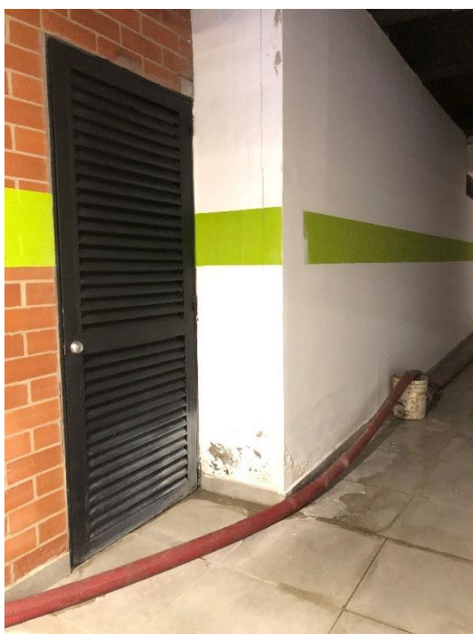
Foto 52. Humedad en muros de cuarto de bombas
