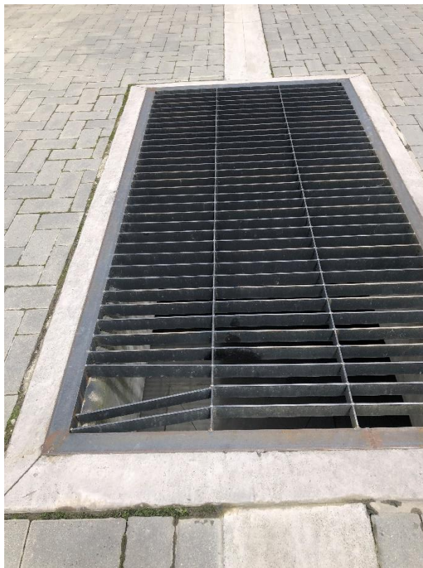
Foto 20 Rejilla de ventilación frente el parqueadero 96 y 15
