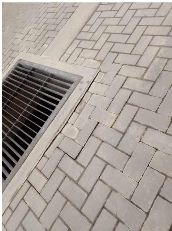
Foto 8. Adoquín circulación vehicular suelto
