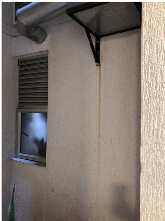
Foto 154. machas de oxido
