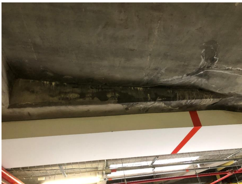
Foto 36. Humedad por filtración desde P1-rampa
