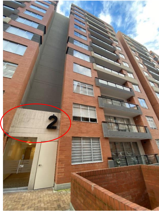
Foto 120. manchas negras y deterioro de pintura
