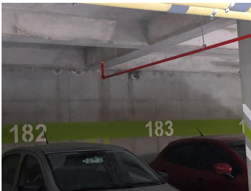
Foto 49. humedad parqueadero 182 y 183
