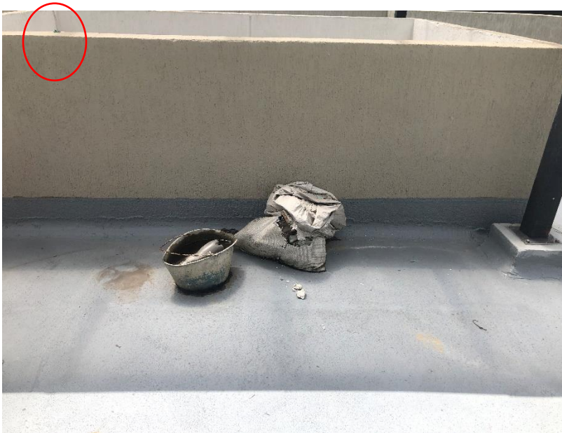
Foto 87. Residuos de obra y Sellar tubería
