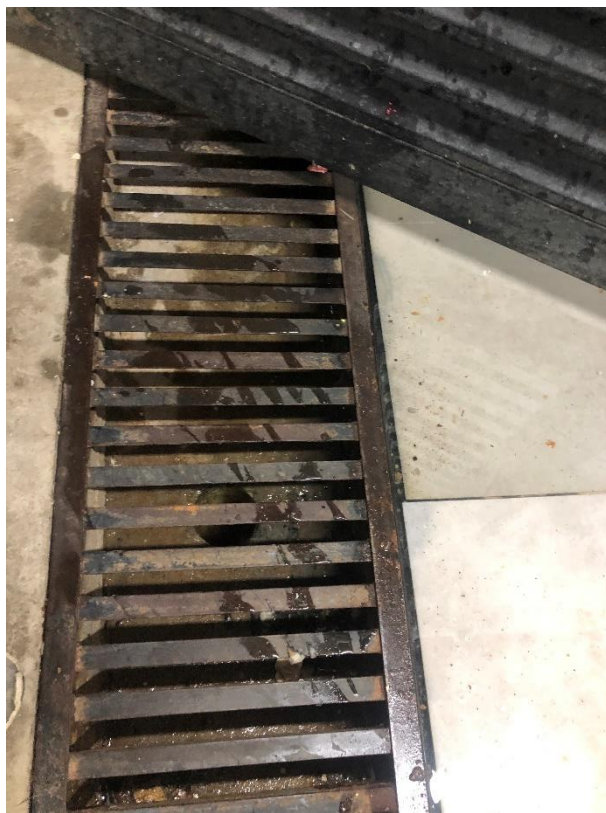
Foto 55. Sifón sin rejilla cuarto de basuras Torre 2
