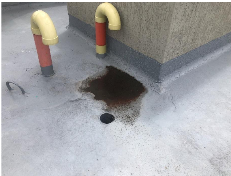
Foto 79. Sifones sin rejillas y empozamientos de agua
