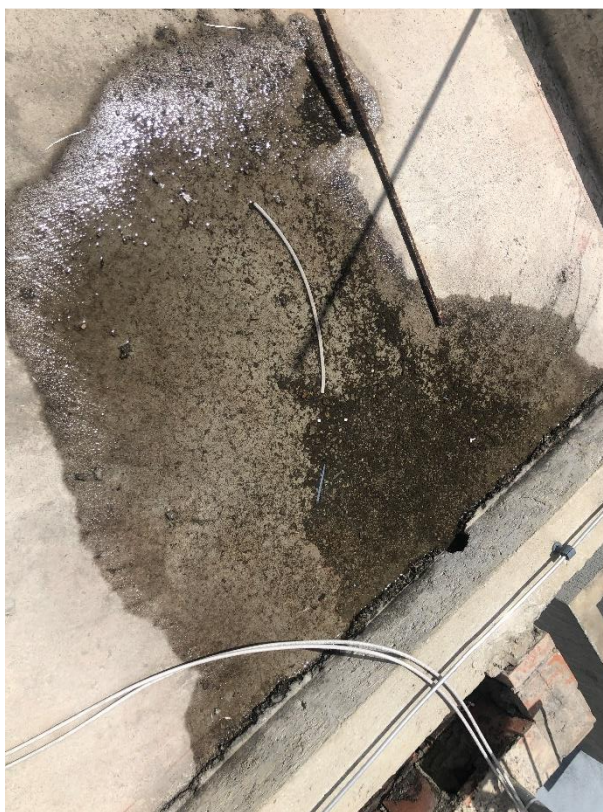
Foto 81. Cubierta de ascensor con empozamiento de agua
