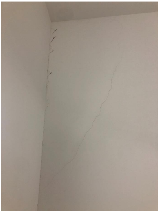
Foto 169. Fisuras generales en halls
