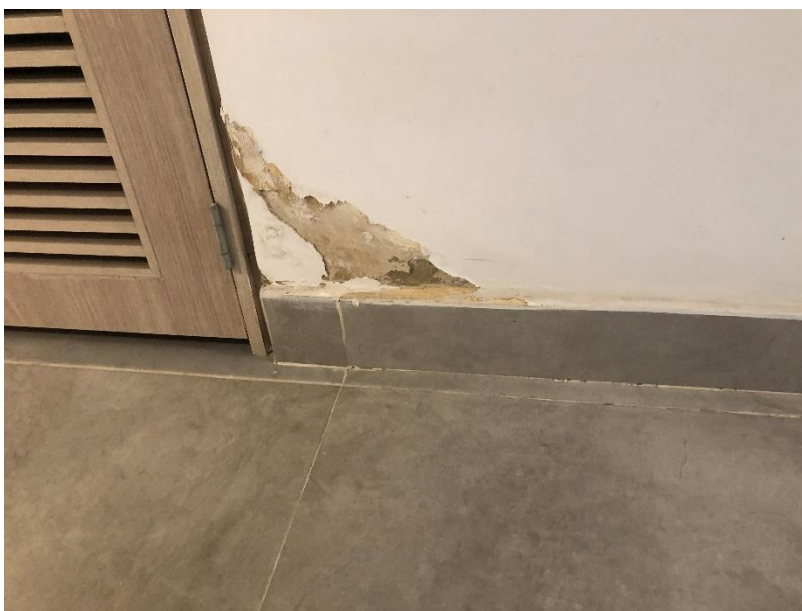
Foto 176. Humedad desde cuarto desde medidores 101-102
