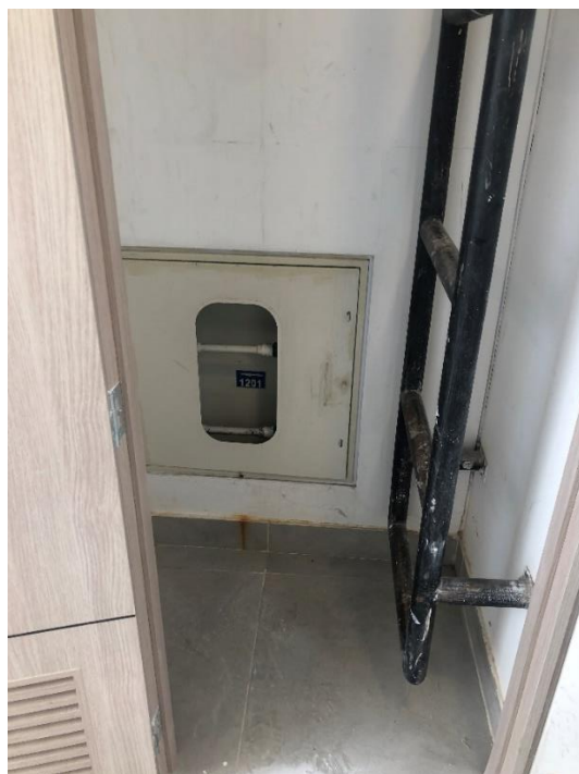
Foto 85. Manchas de oxido
