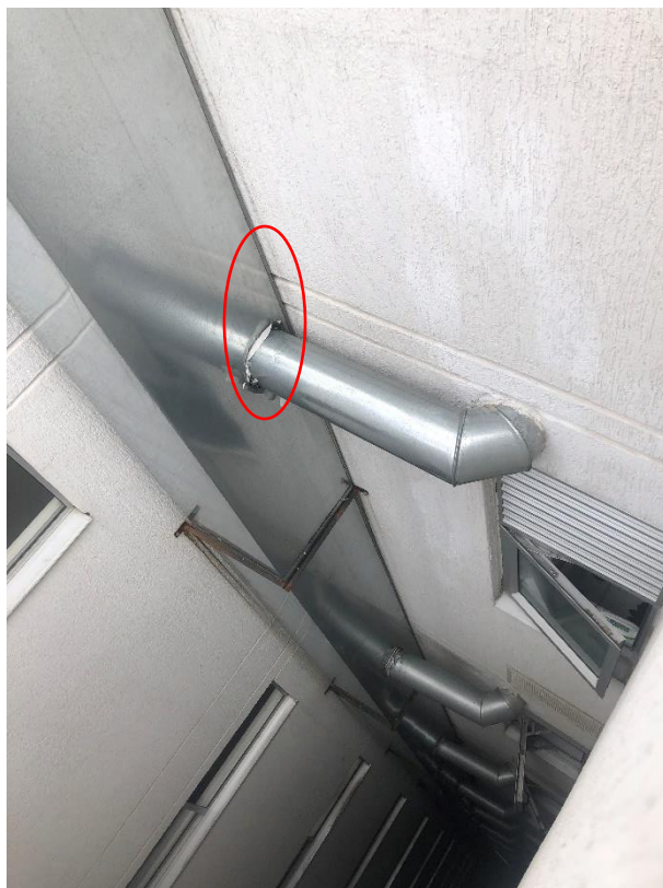
Foto 162. Remate de ducto
