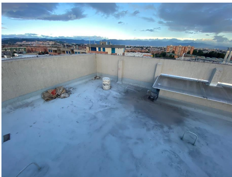
Foto 123. residuos de construcción en cubierta
