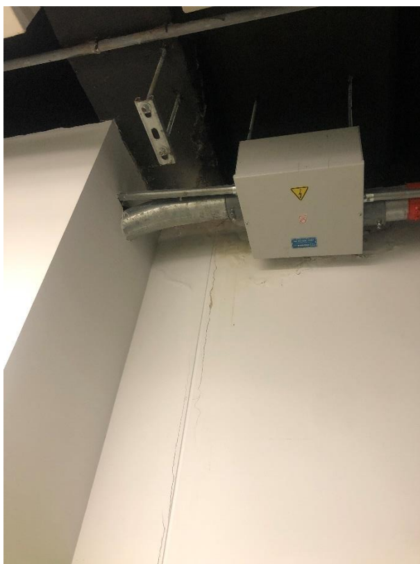
Foto 39. humedad placa de techo torre 5
