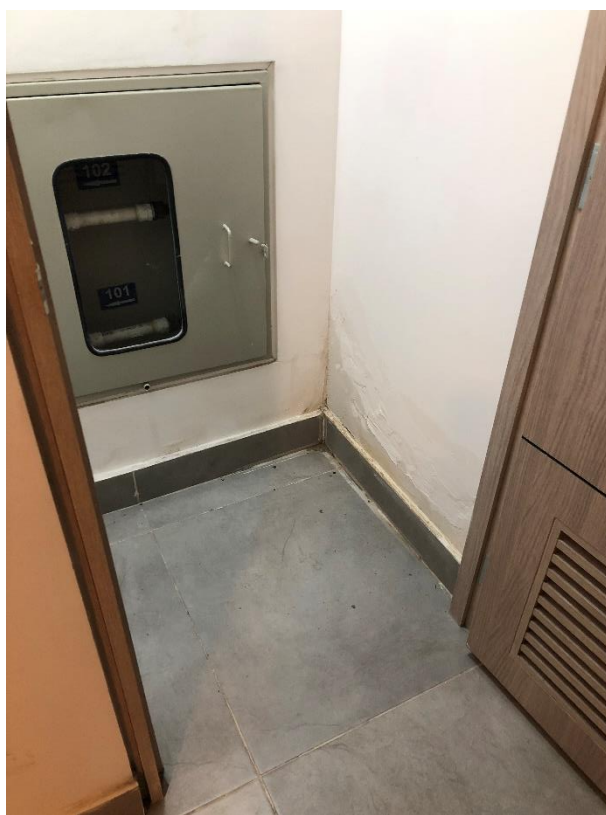
Foto 178. Humedad cuarto medidores 101-102
