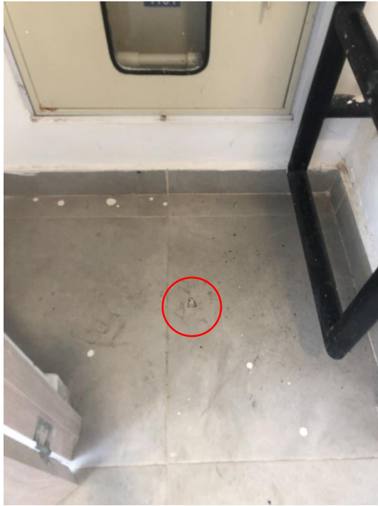
Foto 144. manchas de pintura y piso desportillado
