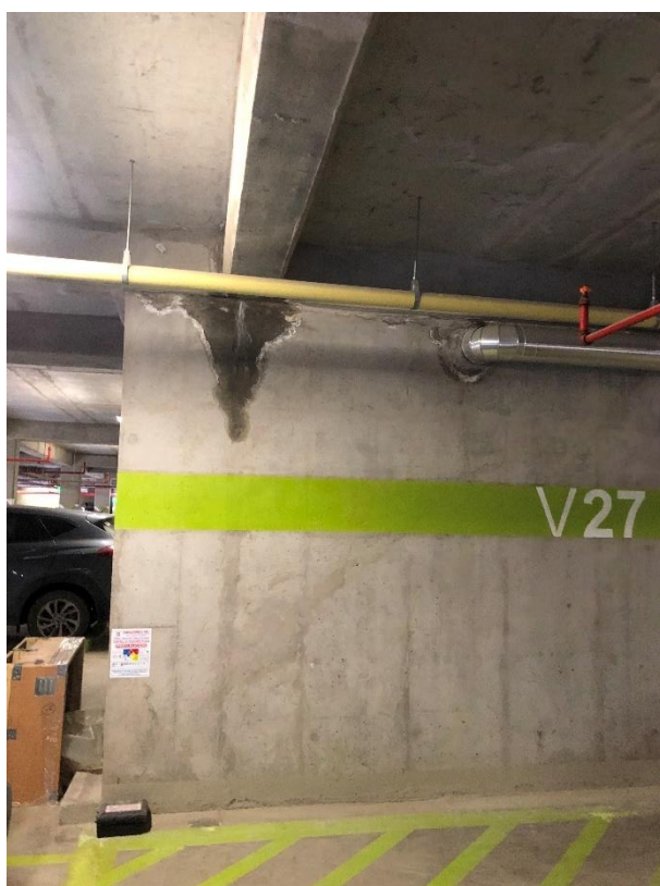
Foto 44. Humedad parqueadero V 27
