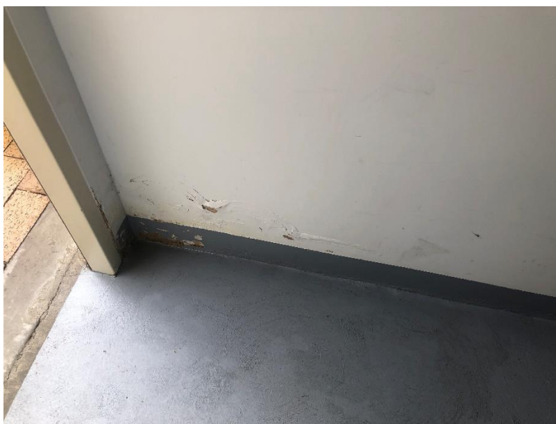
Foto 101. Humedad a la entrada de la torre
