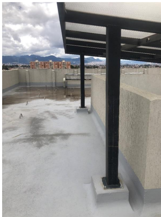
Foto 167. empozamiento de agua en cubierta
