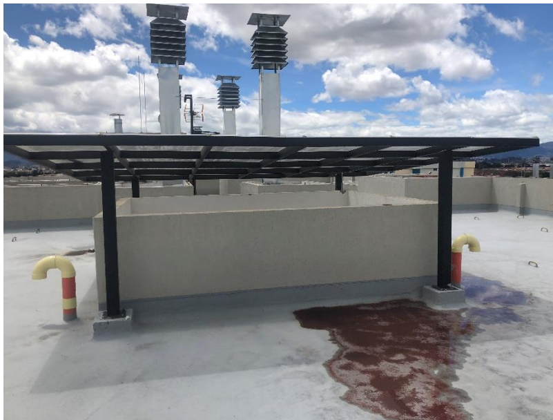
Foto 106. Empozamientos de agua en cubierta
