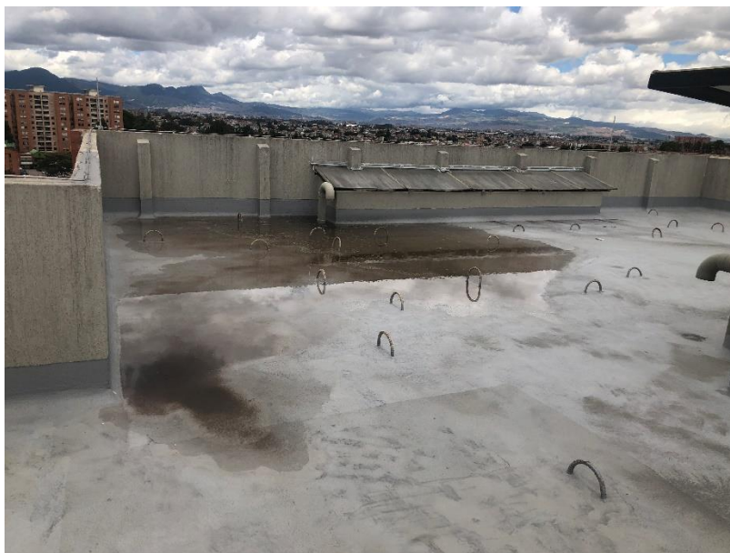
Foto 158. Empozamientos de agua en cubierta
