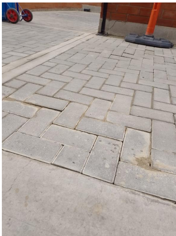
Foto 7. Adoquín circulación vehicular suelto
