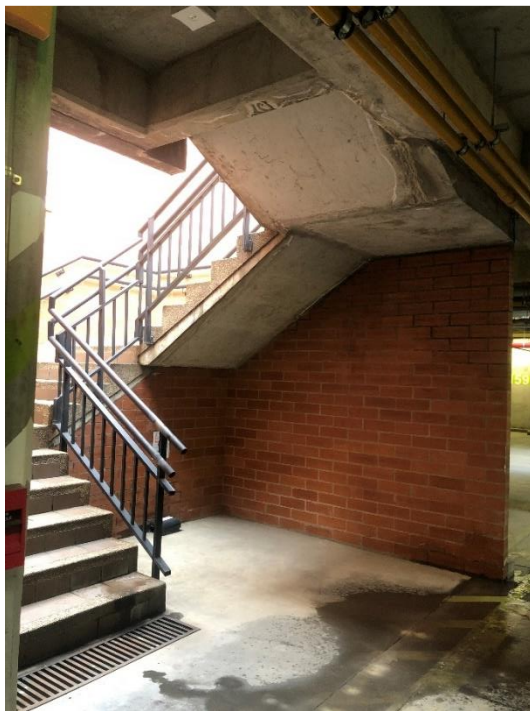
Foto 40 humedad por escalera cercana al parqueadero 215
