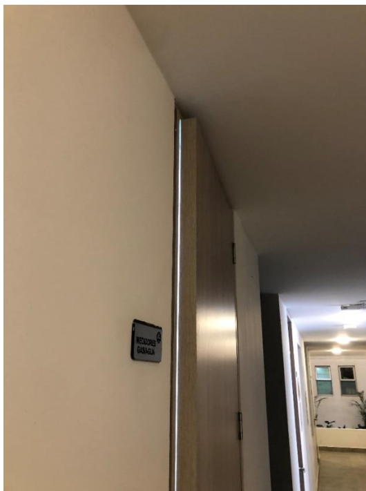
Foto 180. puerta 101-102cuarto de medidores no cierra
