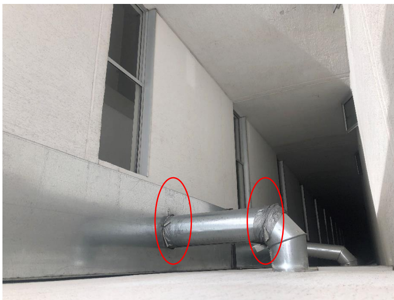
Foto 163. Remate de ducto
