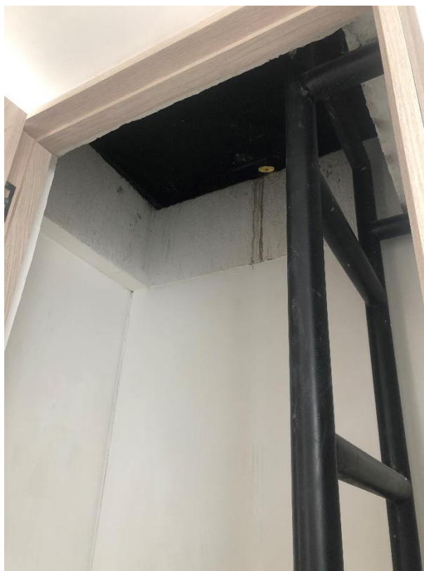
Foto 117. verificar filtración de agua por claraboya
