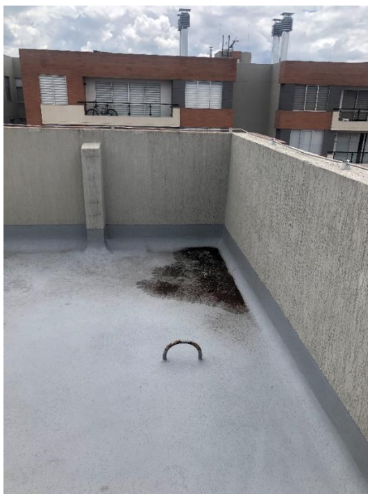
Foto 165. Empozamiento de agua
