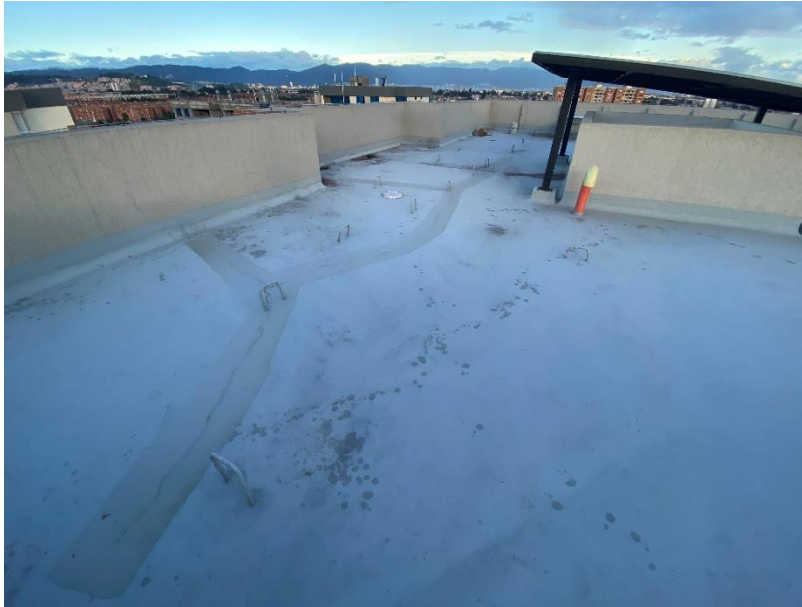
Foto 124. Resanes de impermeabilización
