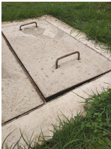
Foto 14. Tapas de inspección no cierran correctamente
