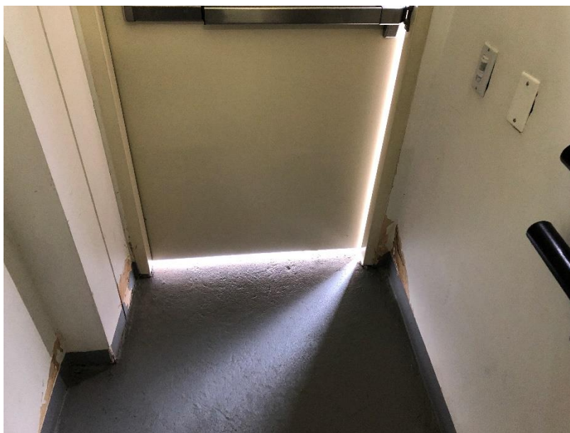
Foto 174. humedad en ingreso a escaleras
