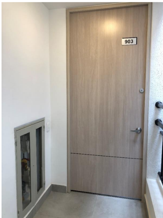
Foto 170. falta vidrio gabinete 903
