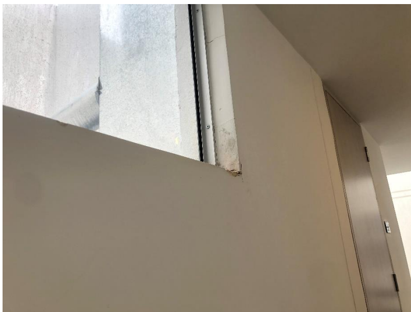
Foto 147. Fisuras y humedad contra ventana P10
