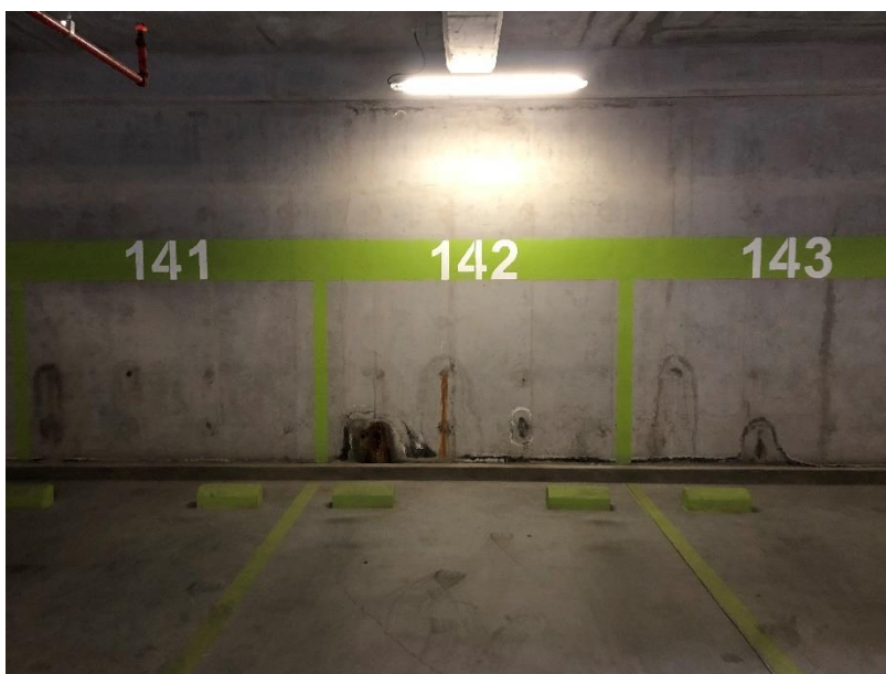
Foto 43. Humedad muro de parqueaderos 141, 142 y 143
