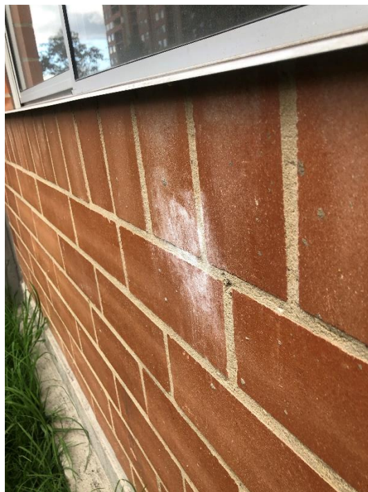
Foto 137. eflorescencia fachada posterior torre 3
