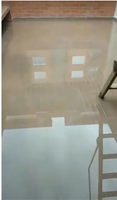
Foto 32. empozamiento de agua en terraza BBQ
