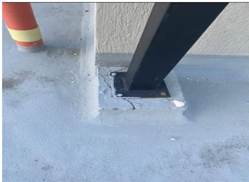
Foto 116 Pedestal de la cubierta marquesina fisurado
