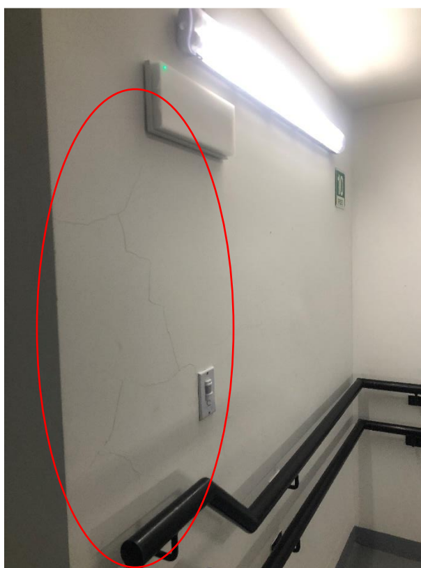
Foto 91. Fisuras punto fijo escaleras
