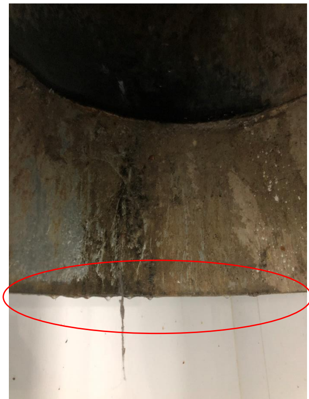
Foto 57. Filtración por ducto de basuras Torre 2
