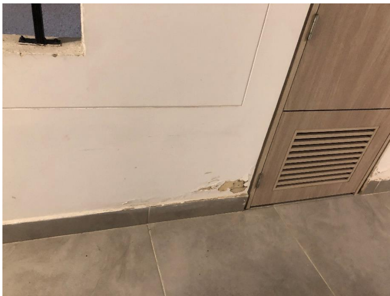
Foto 156. verificar humedad al lado de medidores apto 103
