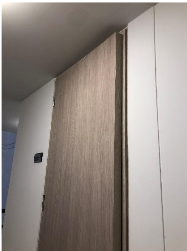
Foto 173. puerta caída no cierra Cuarto de medidores 301-302
