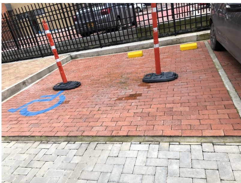
Foto 22. Parqueadero V21 sin demarcación
