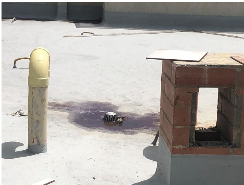
Foto 108. Empozamientos de agua
