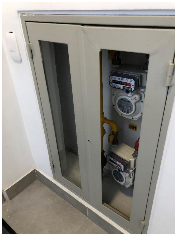
Foto 171. falta vidrio gabinete 901
