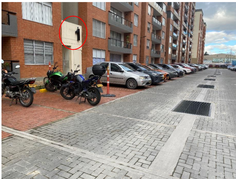
Foto 104. Manchas negra y deterioro de pintura
