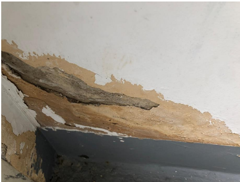
Foto 175. Humedad en ingreso a escaleras
