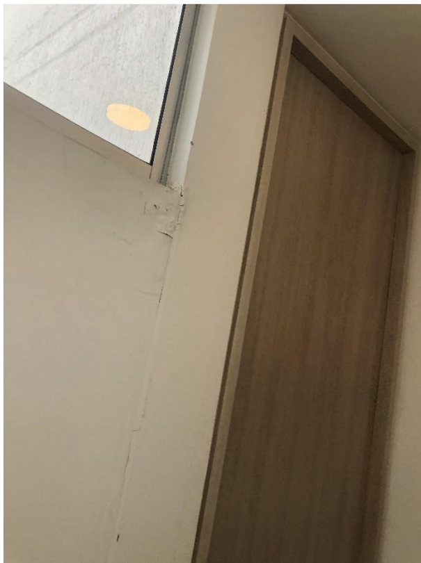
Foto 146. Fisura y humedad contra ventana P11
