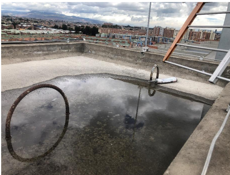
Foto 168. empozamiento de agua en cubierta de ascensor
