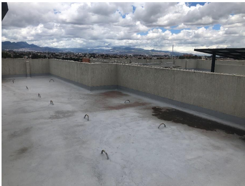
Foto 141. Empozamiento de agua
