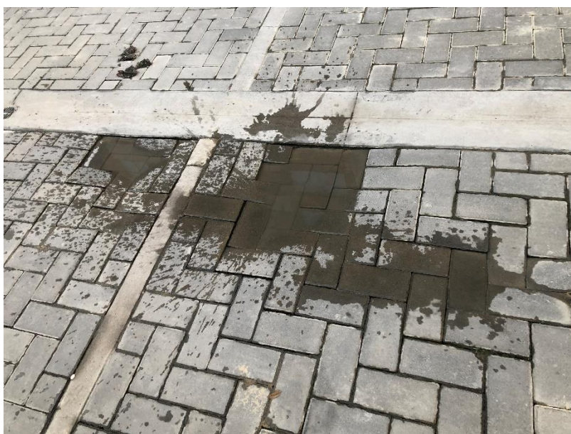
Foto 9. Hundimiento de Adoquin
