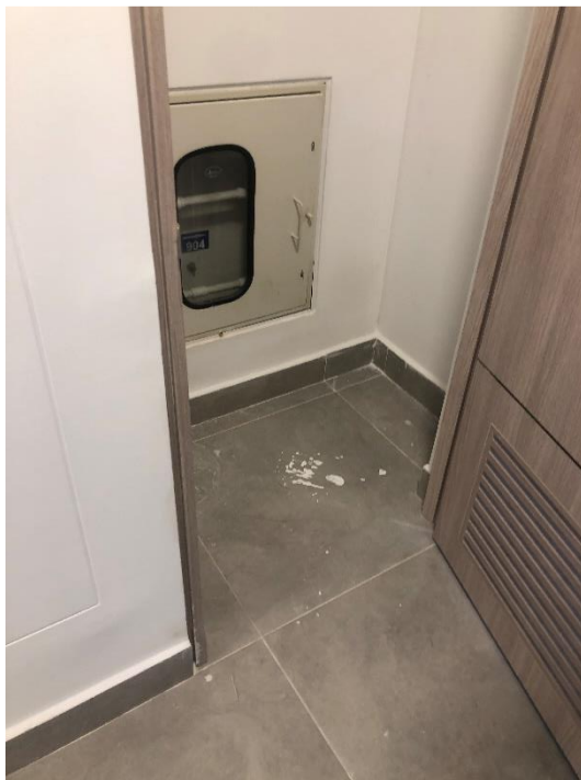
Foto 94. Manchas de pintura en piso
