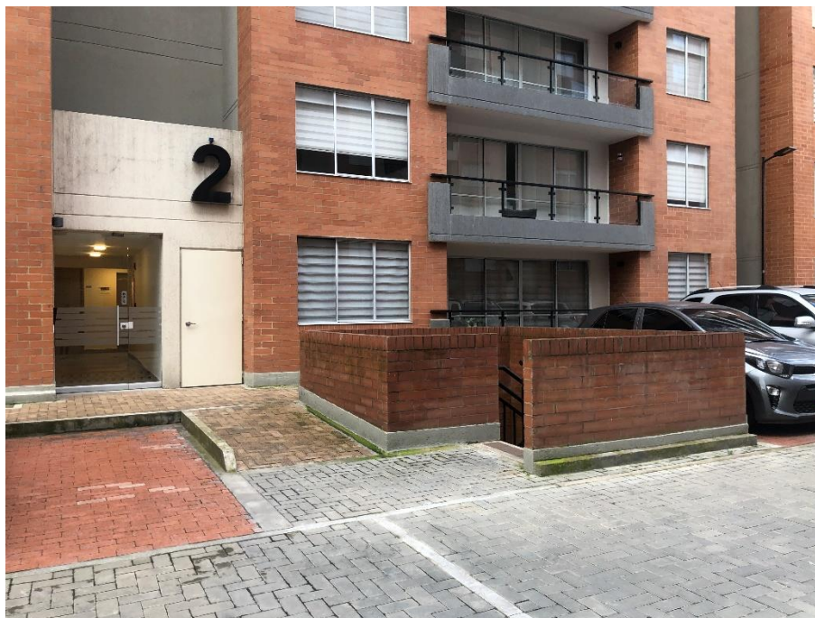
Foto 4. Humedad en escaleras frente a torre 2
