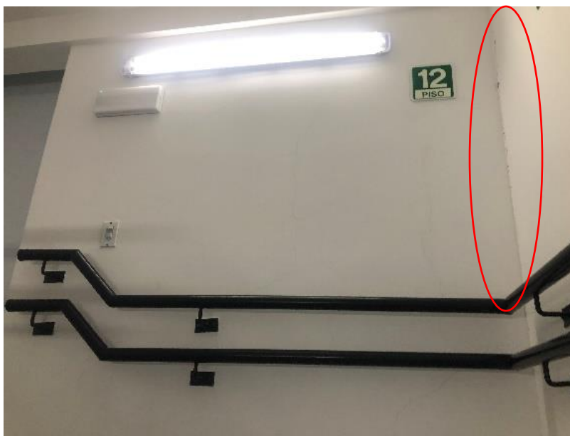
Foto 90. Fisuras en Punto fijo Escaleras
