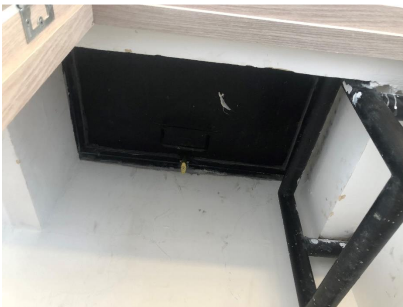
Foto 143. Manchas de pintura, filtraciones por claraboya
