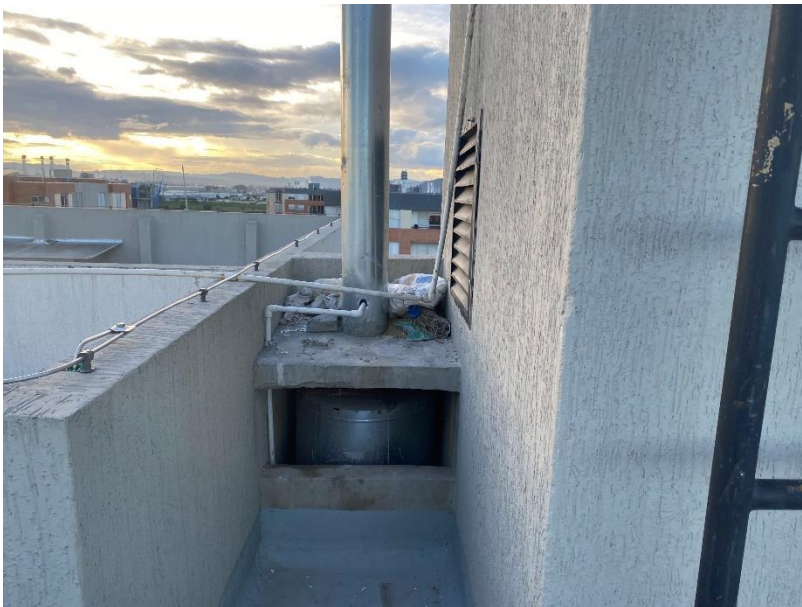
Foto 125. Falta rejilla y retirar escombros
