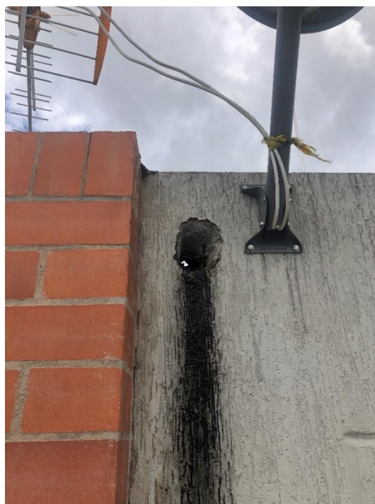
Foto 161. Desagüe cubierta de ascensor
