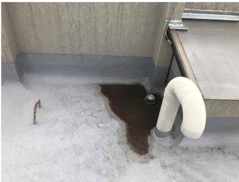
Foto 142. empozamientos de agua
