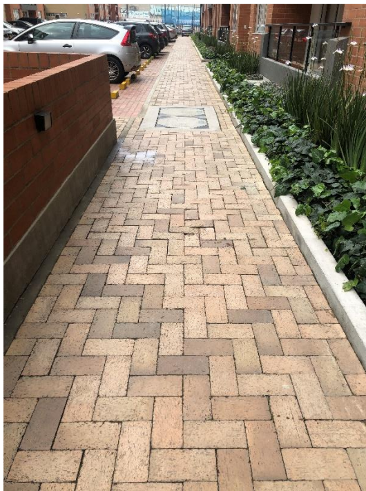
Foto 12. Adoquín circulación peatonal frente a torre 5 suelto
