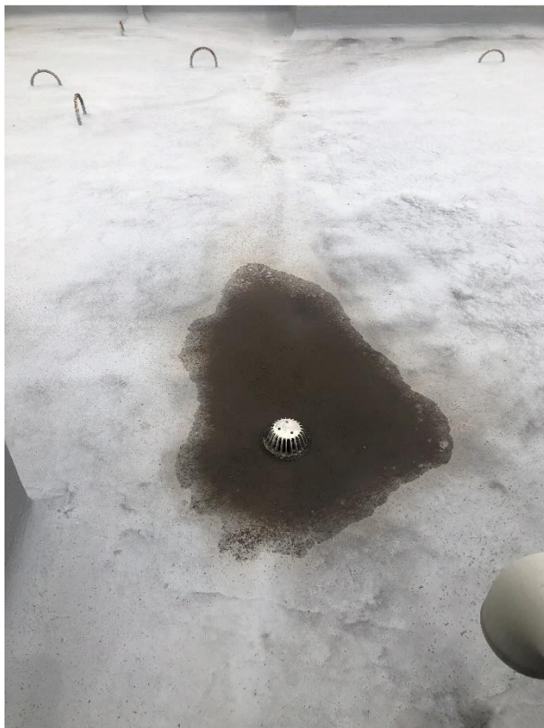
Foto 164. Empozamiento de agua
