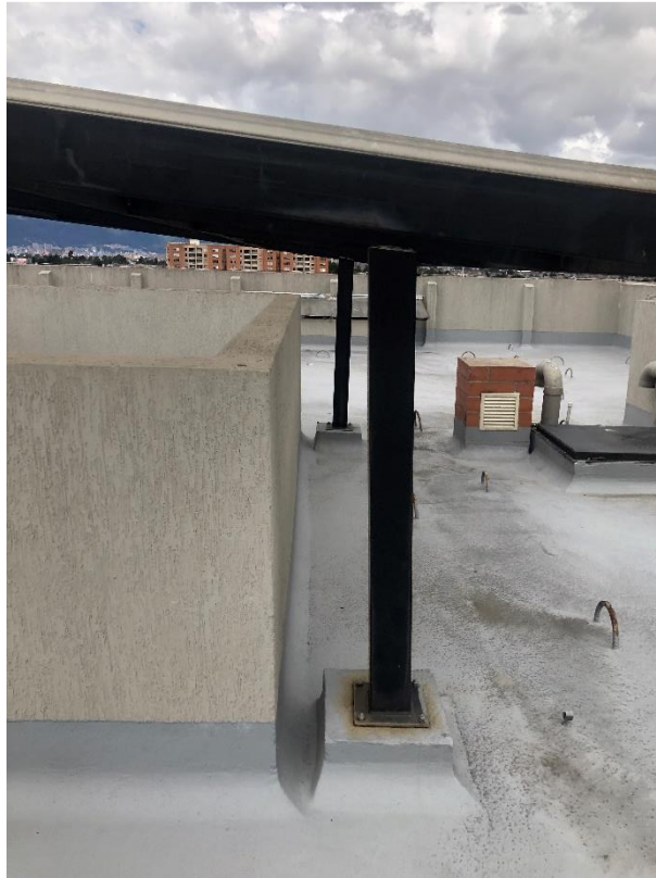
Foto 166. Oxido en parales de marquesina
