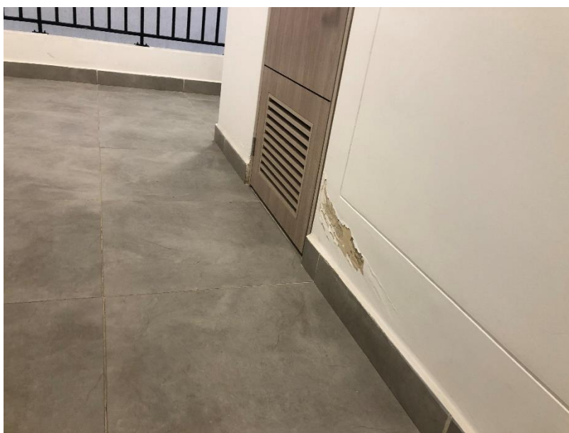
Foto 151. pared con pintura levantada piso 3
