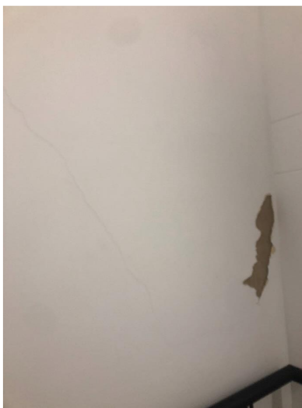
Foto 149. desprendimiento y fisuras en punto fijo escaleras
