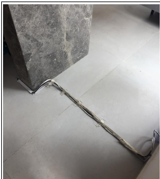
Fotografía 18. Red de citofonía. Fuente propia.
