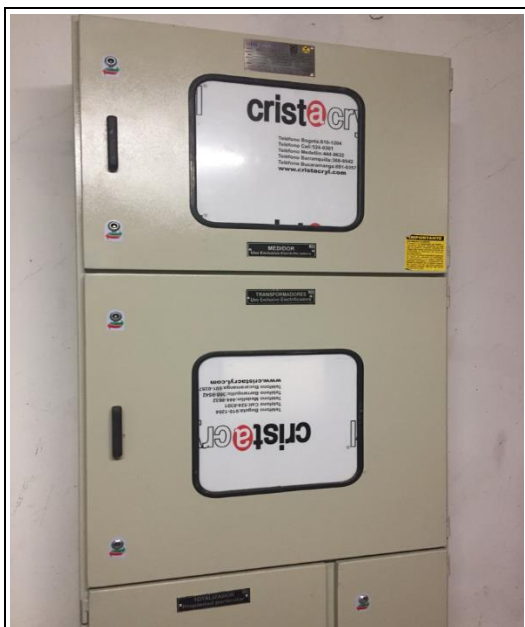
Fotografía 7. Gabinete del contador de servicios comunes. Fuente propia.
