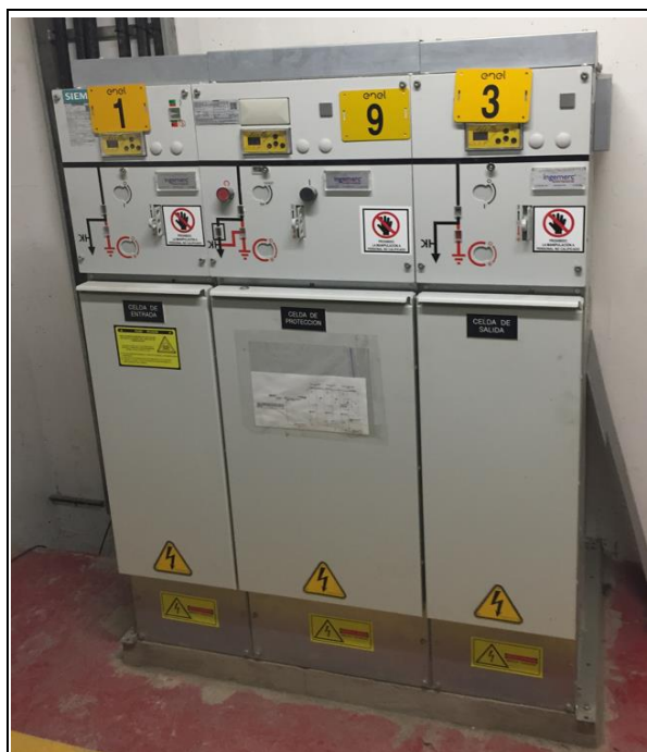
Fotografía 3. Tren de celdas MT. Fuente propia.
