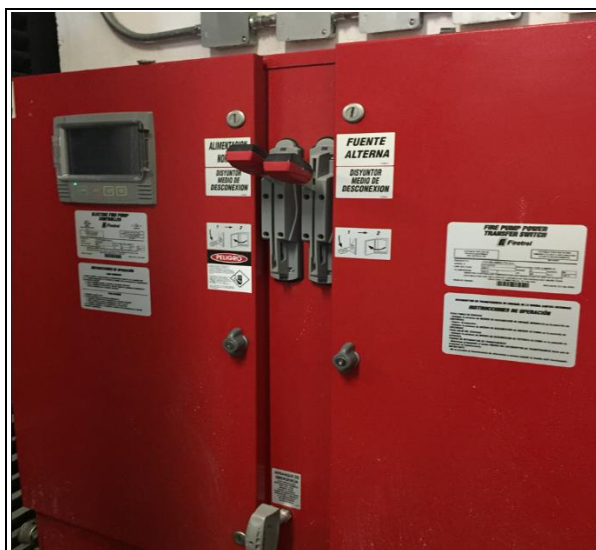
Fotografía 12. Tablero de control sistema contraincendios. Fuente propia.
