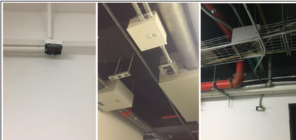
Fotografía 21. Cajas eléctricas de Paso. Fuente propia.
