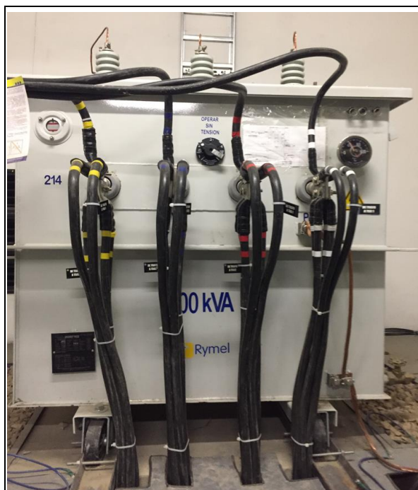
Fotografía 2. Transformador de distribución. Fuente propia.
