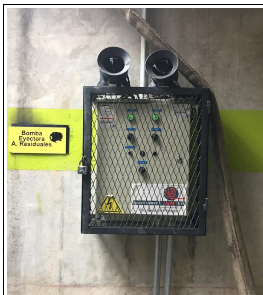
Fotografía 13. Tablero de control sistema de bombas eyectoras. Fuente propia.
