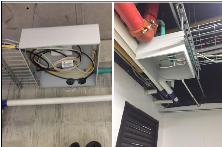
Fotografía 19. Red de comunicaciones. Fuente propia.
