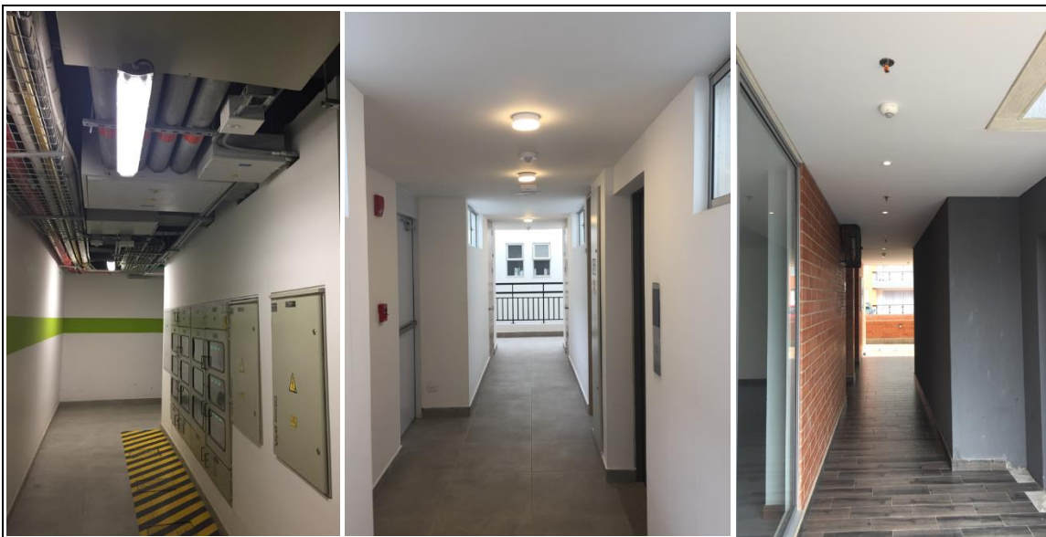
Fotografía 15. Sistema de iluminación interior. Fuente propia.
