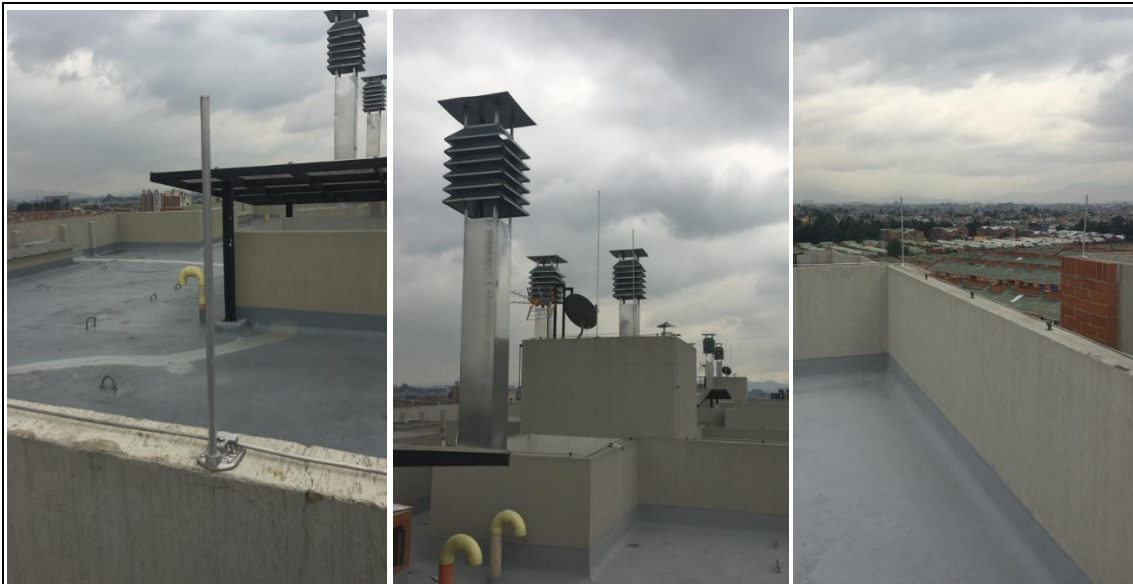
Fotografía 16. Sistema de apantallamiento. Fuente propia.
