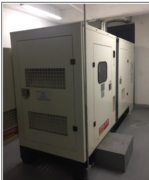
Fotografía 9. Planta de emergencia. Fuente propia.
